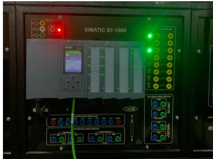
Figura 3.36: Prueba de funcionamiento 5.
