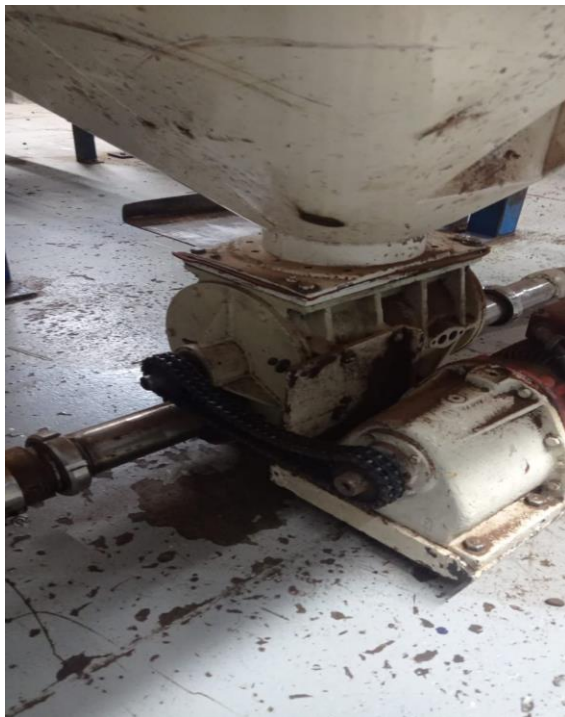
Figura 5: Cadena en movimiento sin guarda de seguridad
