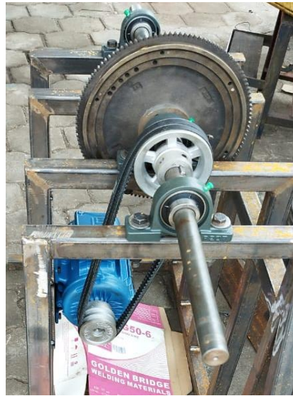
Figura 3.5 - Motor eléctrico instalado
