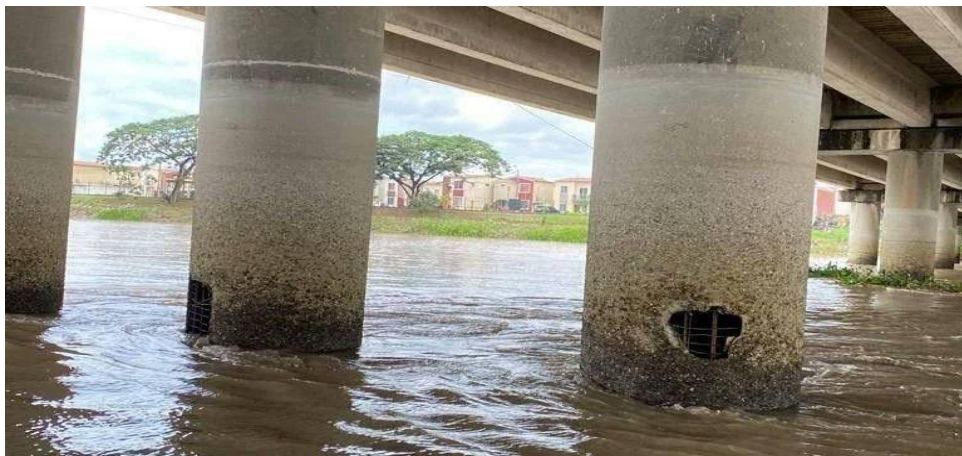
Figura 2-25 Graves afectaciones en los pilotes que soportan la estructura del puente que conecta Guayaquil con Daule, Ecuador (abril-2022). Fuente: Autores.
