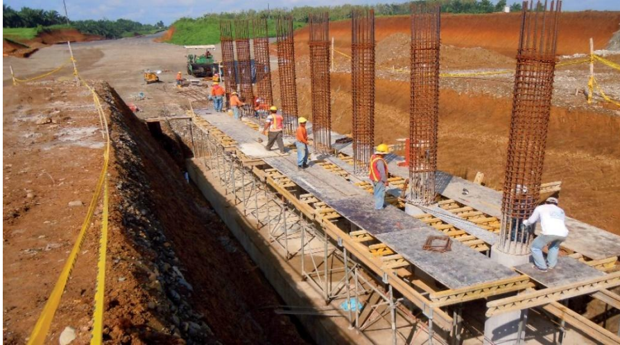
Figura 2-26 Cimentación del puente sobre el río Lulo-Los Ríos- Ecuador (octubre-2017). Fuente: Autores.
