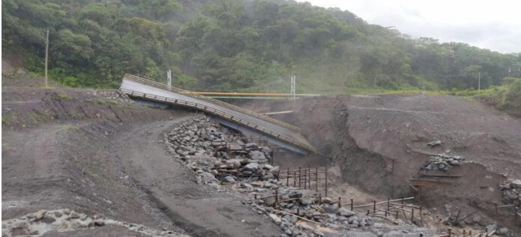
Figura 2-33 Caída del puente en río Marker-Ecuador por el empuje de tierra (febrero-2023). Fuente: Autores.
