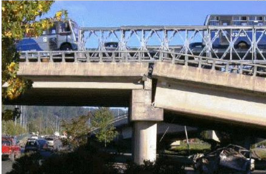
Figura 2-32 Una carga sísmica afectó al puente Arroyito-Argentina. Fuente: SciELO
