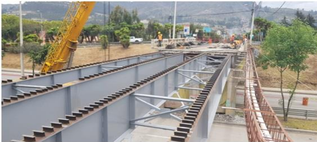
Figura 2-5 El puente vehicular y peatonal, Sixto Durán Ballén, situado en el kilómetro 17 de la vía Cuenca – Azogues (noviembre 2019). Fuente: Autores.
