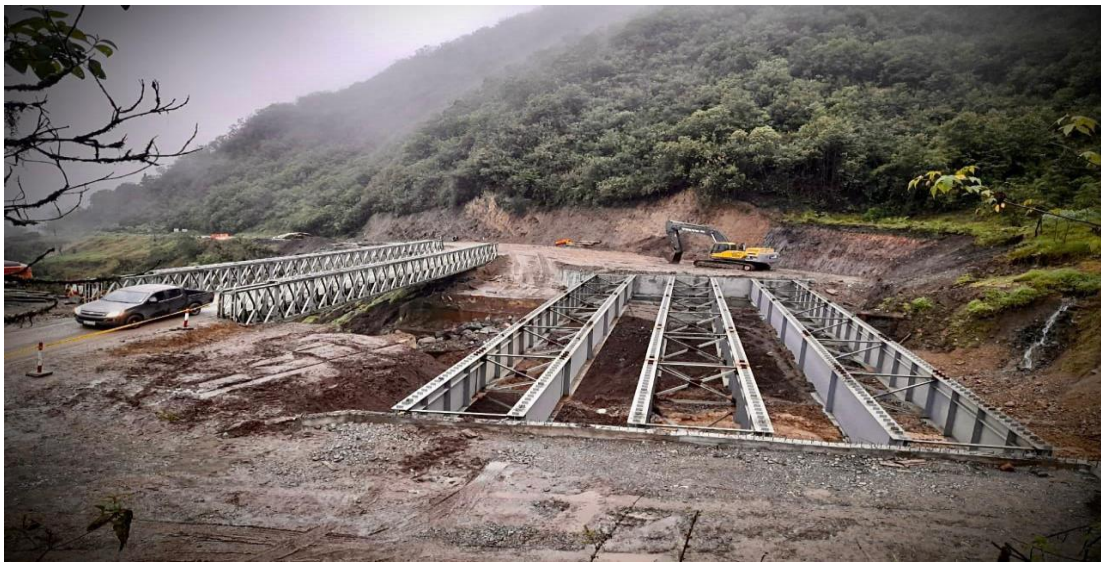
Figura 2-29 Las vigas del puente Tinieblas-Latacunga-Ecuador pertenece a la carga permanente. Fuente: Autores.
