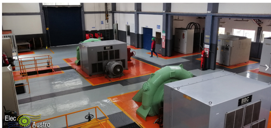
Figura 8: Cuarto de maquinas central hidroeléctrica Saymirin V [75].
