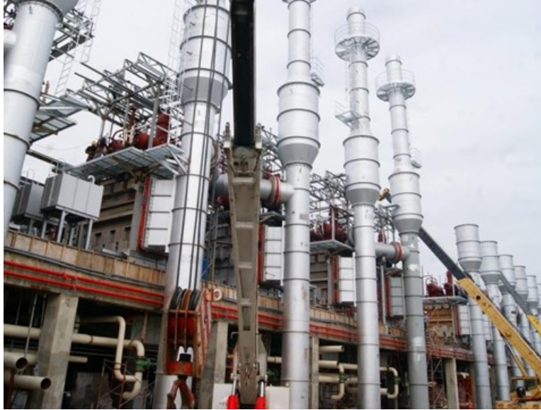
Figura 5: Central Térmica - Esmeraldas [19].
