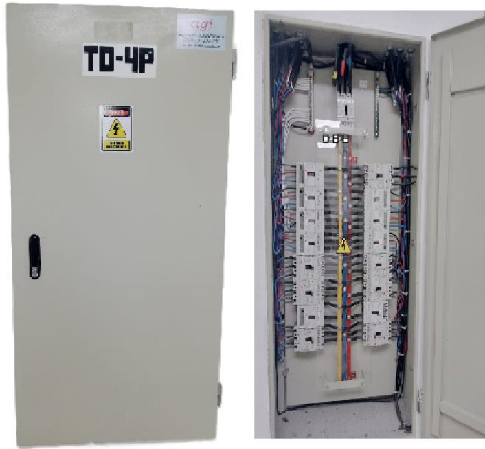
Figura 18. Centro de carga, punto de conexión del sistema fotovoltaico.
