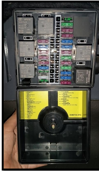
Caja de control y seguridad eléctrica del equipo. Fuente: Daniel Ayala.
