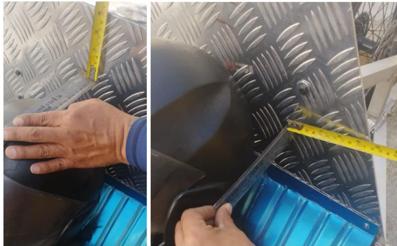
Figura 5.3: Deformación del Mamparo.
