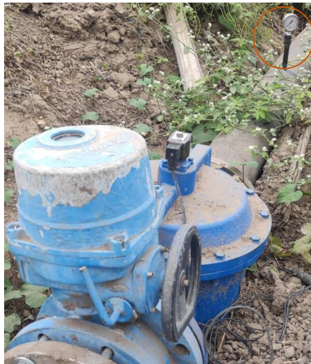
Figura 36. Control de válvulas.
