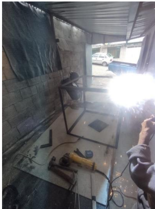
Figura:4.1 Creación del marco externo del prototipo de generación eléctrica
