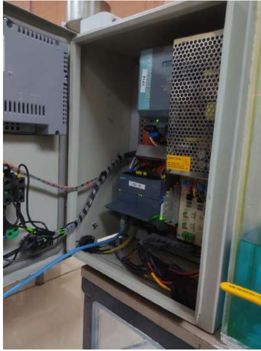
Figura 21. Tablero planta 3 tanques. Fuente: Autores.
