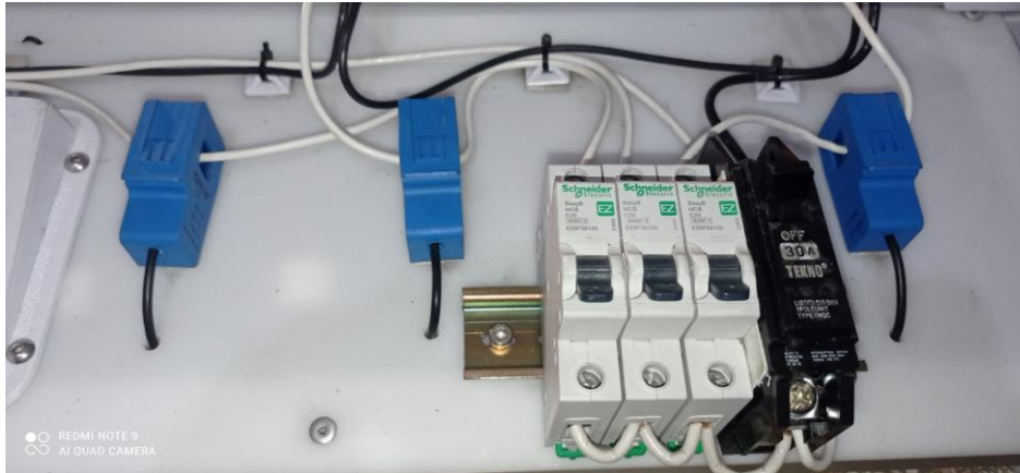
Figura 35 Sensores de consumo eléctrico y breakers
