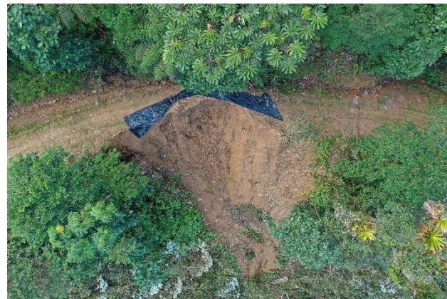
Figura 11. Falla de talud de suelo in situ.
