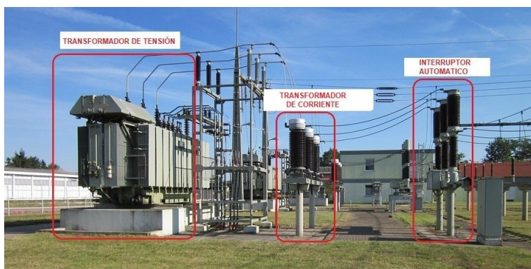
Figura 2.2: Transformador de Tensión y Transformador de Corriente
