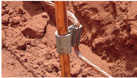
Figura 2.9: Cables de Conexión
