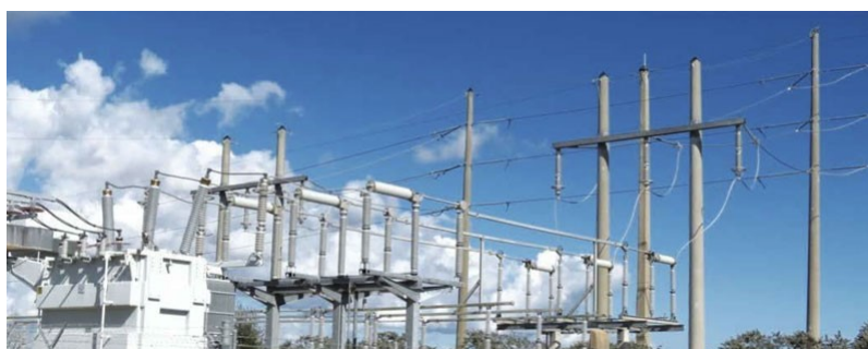
Figura 2.3: Transformador de Tensión y Transformador de Corriente
