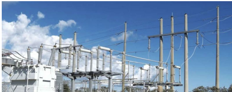
Figura 2.3: Transformador de Tensión y Transformador de Corriente
