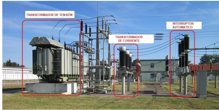
Figura 2.2: Transformador de Tensión y Transformador de Corriente
