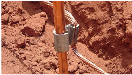
Figura 2.9: Cables de Conexión
