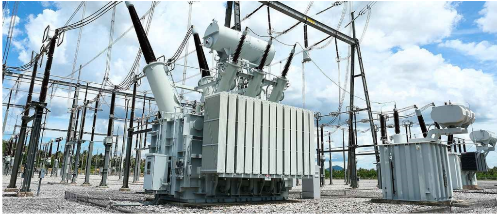
Figura 2.4: Transformador de Tensión y Transformador de Corriente
