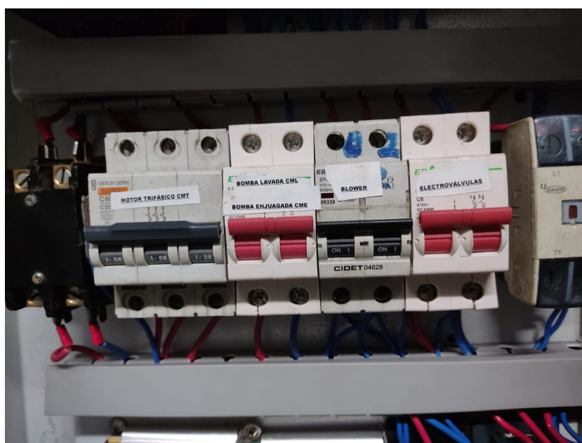
Figura 92. Disyuntores para los motores Fuente: Realizado por Daniel Remache y Josh Sud
