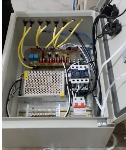
Figura 63. Implementación del circuito electrónico en tablero de control.
