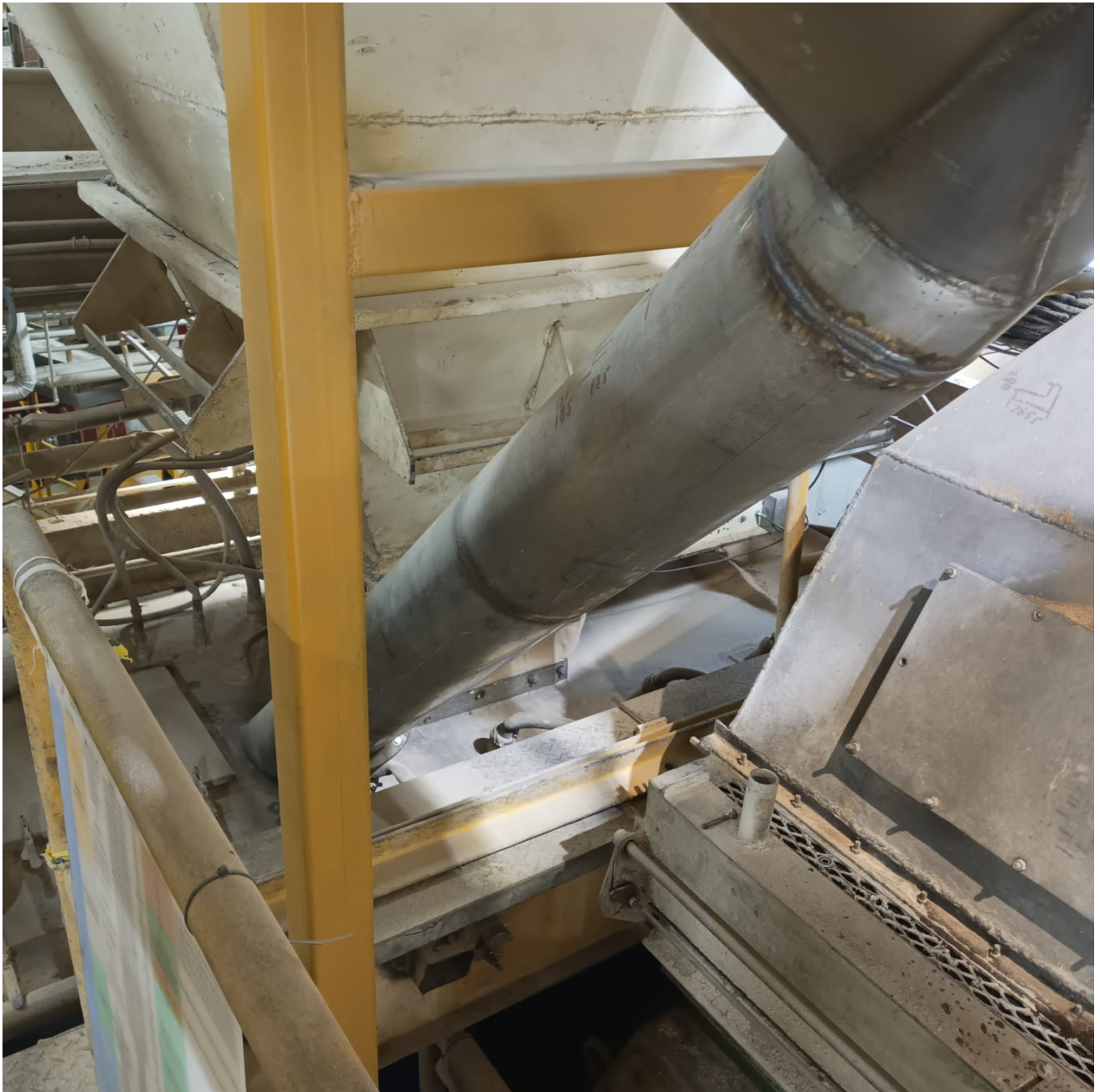
Figura 72: Ducto de tolva buffer hacia mezcladora. Fuente: Autoría Propia
