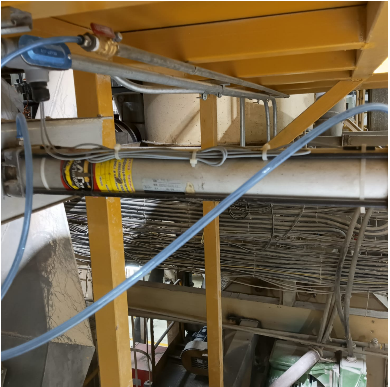
Figura 70: Conexión neumática en electroválvula. Fuente: Autoría Propia
