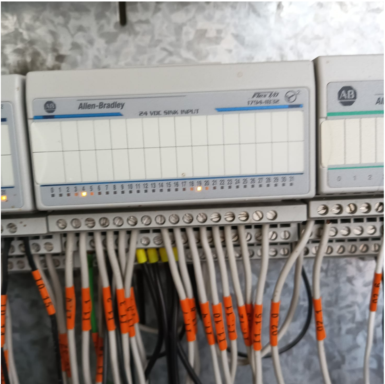
Figura 73: Módulo 1794-IB32 módulos de entradas. Fuente: Autoría Propia
