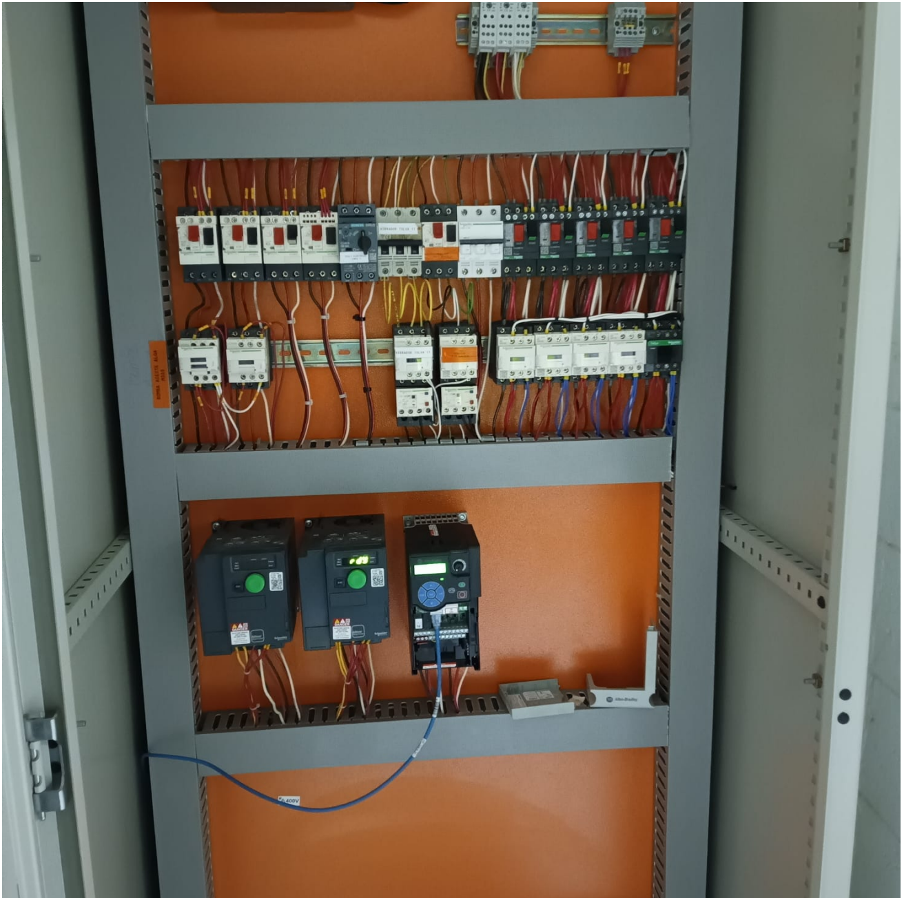
Figura 79: Vista de los arrancadores nuevos implementados. Fuente: Autoría Propia
