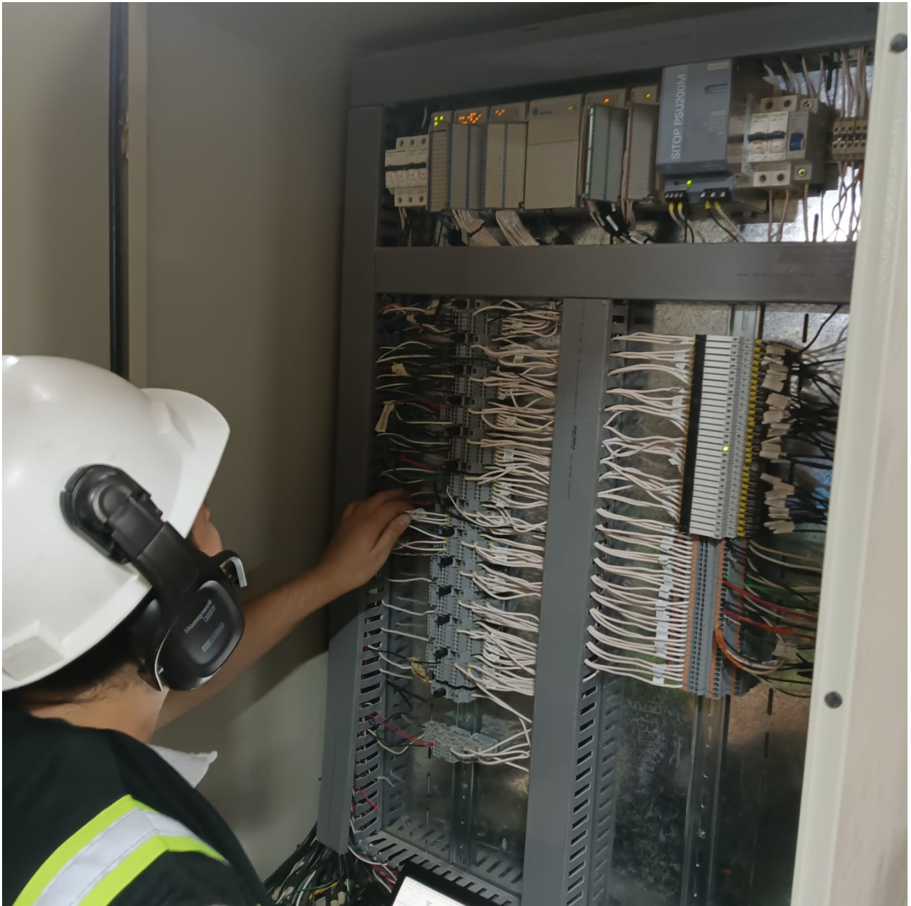
Figura 75: Revisión de señales en tablero de control remoto. Fuente: Autoría Propia
