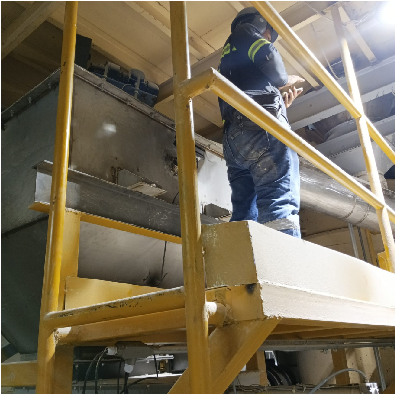
Figura 69: Comisionado de señales nivel alto y bajo en tolva buffer. Fuente: Autoría Propia
