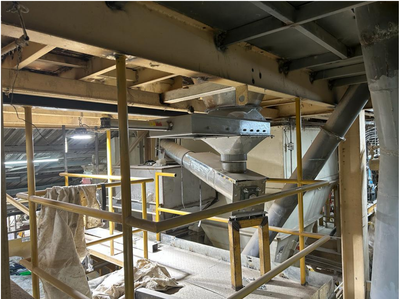
Figura 78: Transportador hacia tolva buffer. Fuente: Autoría Propia
