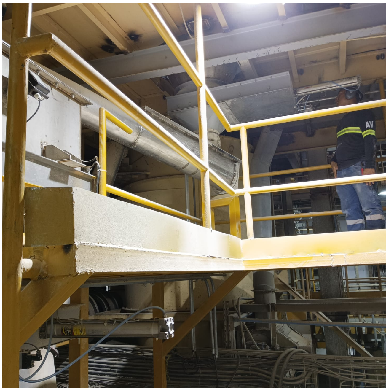
Figura 67: Comisionado de señales (abierto, cerrado) compuerta neumática de balanza. Fuente: Autoría Propia
