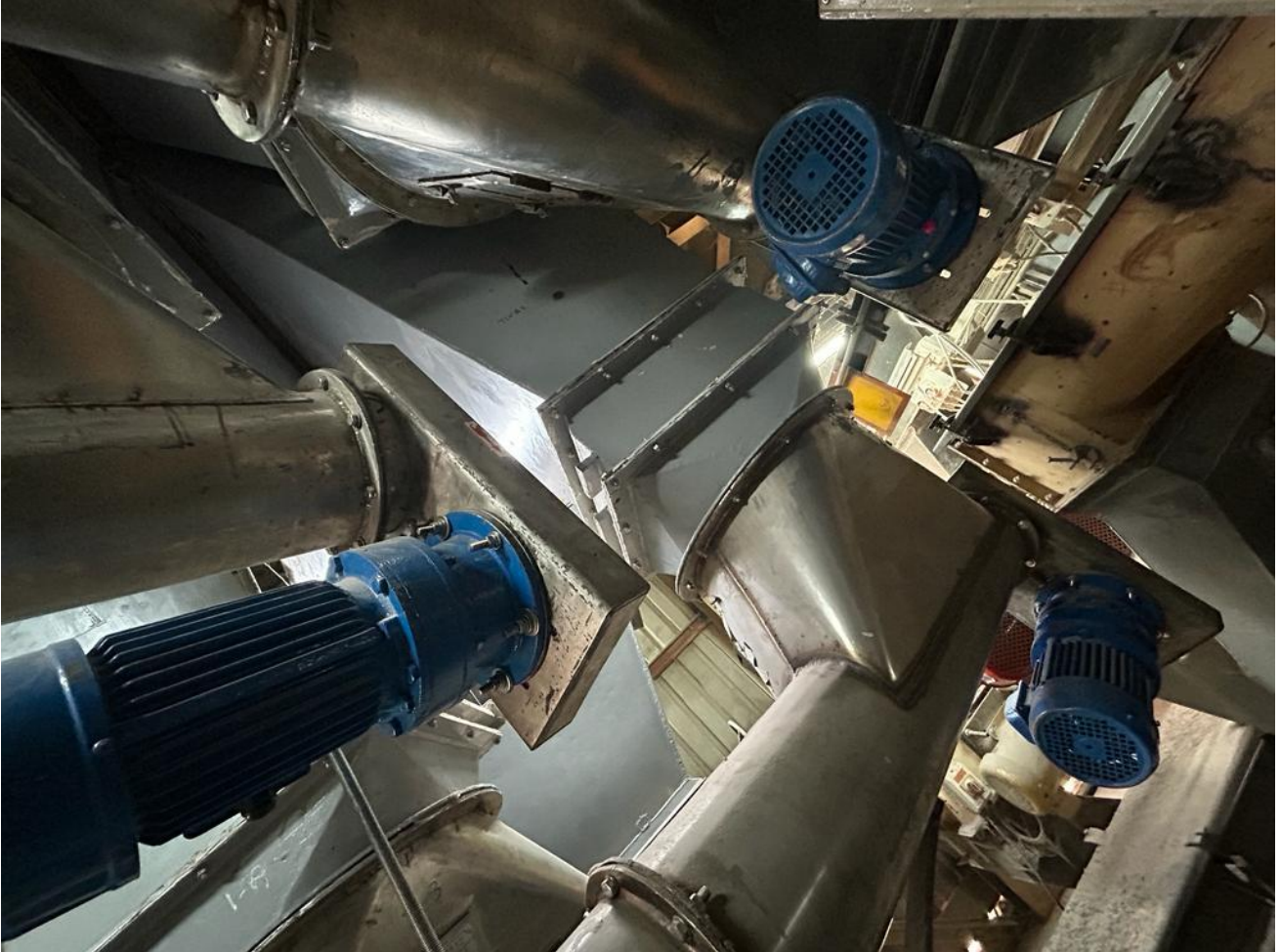
Figura 76: Tolvas de medios. Fuente: Autoría Propia
