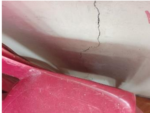
Figura 28. Fisura vertical en pared
