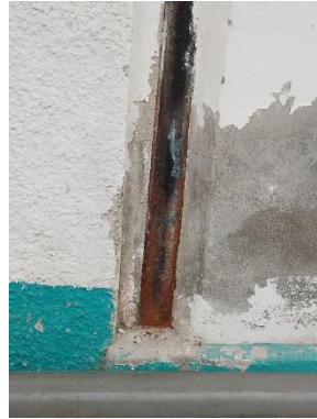
Figura 24. Corrosión en sección de estructura metálica
