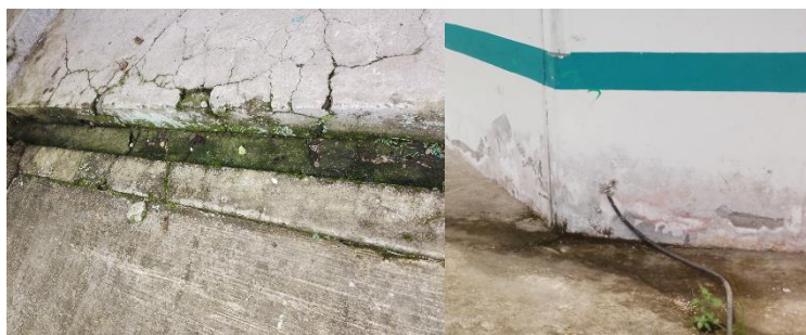
Figura 26. Grietas en concreto debido al crecimiento de plantas y musgo
