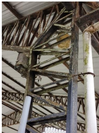
Figura 25. Corrosión en pórtico del coliseo
