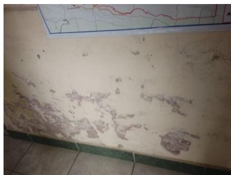
Figura 27. Manchas de humedad y hongos debido a la capilaridad del agua
