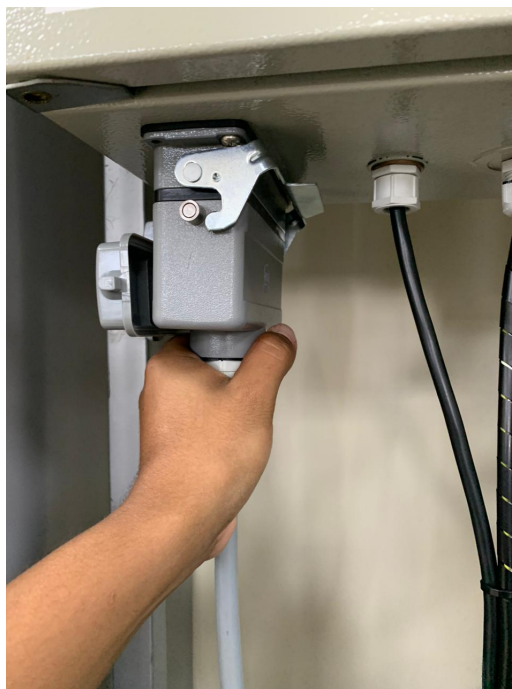
Figura 22: Conexión del clave de comunicación en el tablero eléctrico Fuente: Autores
