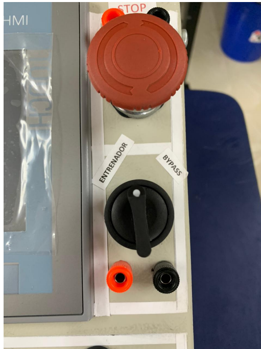
Figura 19: Sistema Bypass con el selector de tres posiciones Fuente: Autores
