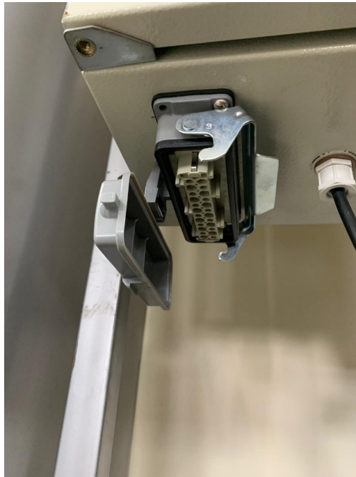
Figura 21: Clavija de comunicación del tablero eléctrico del proyecto car wash Fuente: Autores
