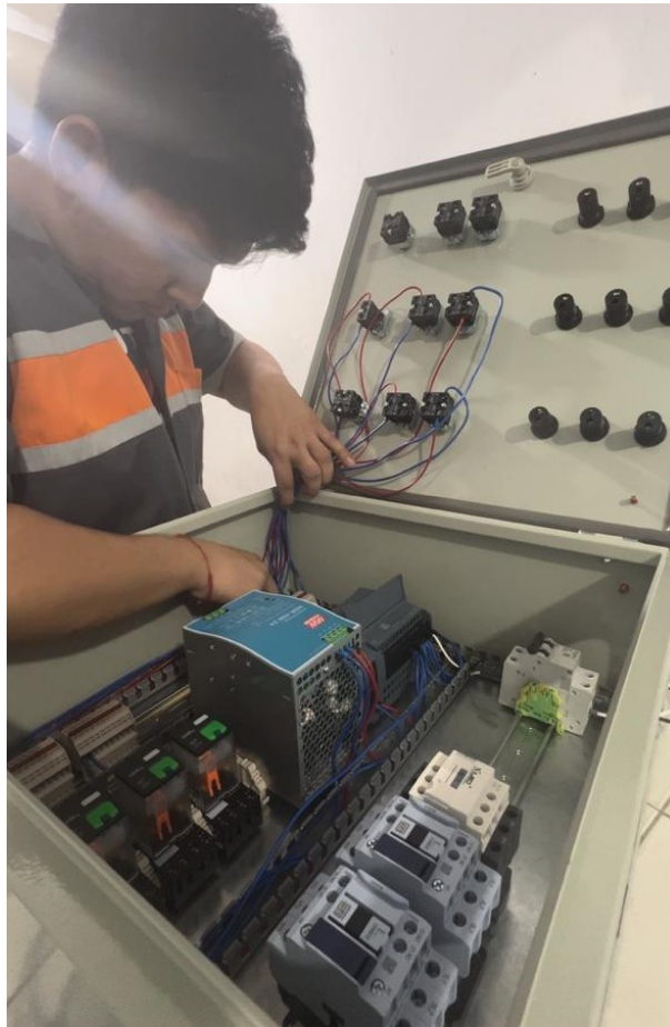
Figura 26. Cableado Del Tablero de Control/Fuerza
