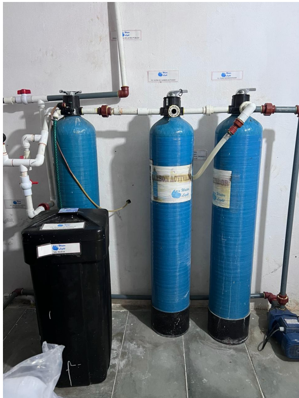
Figura 3. Filtros de Purificación
