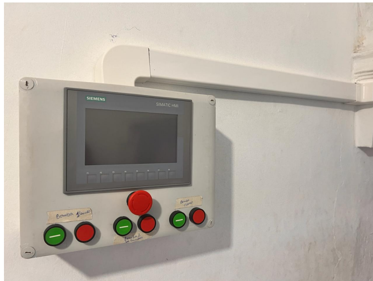
Figura 21. Tablero De Visualización y control de bombas, por J. Solano y D.Ponce, Solidworks, 2022.
