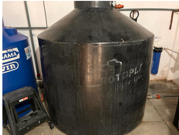
Figura 4. Tanque de Almacenamiento con Agua Filtrada y Ozonizada
