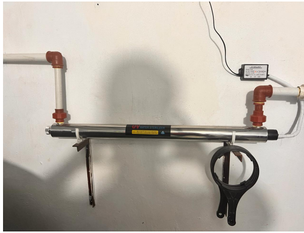
Figura 6. La irradiación ultravioleta aplicada en el proceso de tratamiento del agua para su purificación.
