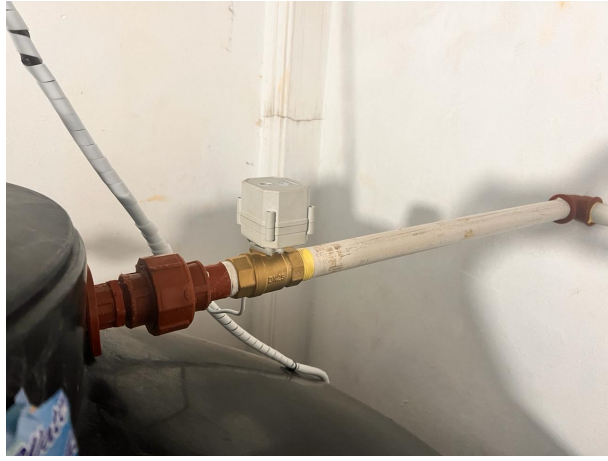
Figura 29. Valvula Motorizada en el Inicio de LLenado del tanque de Agua Filtrada
