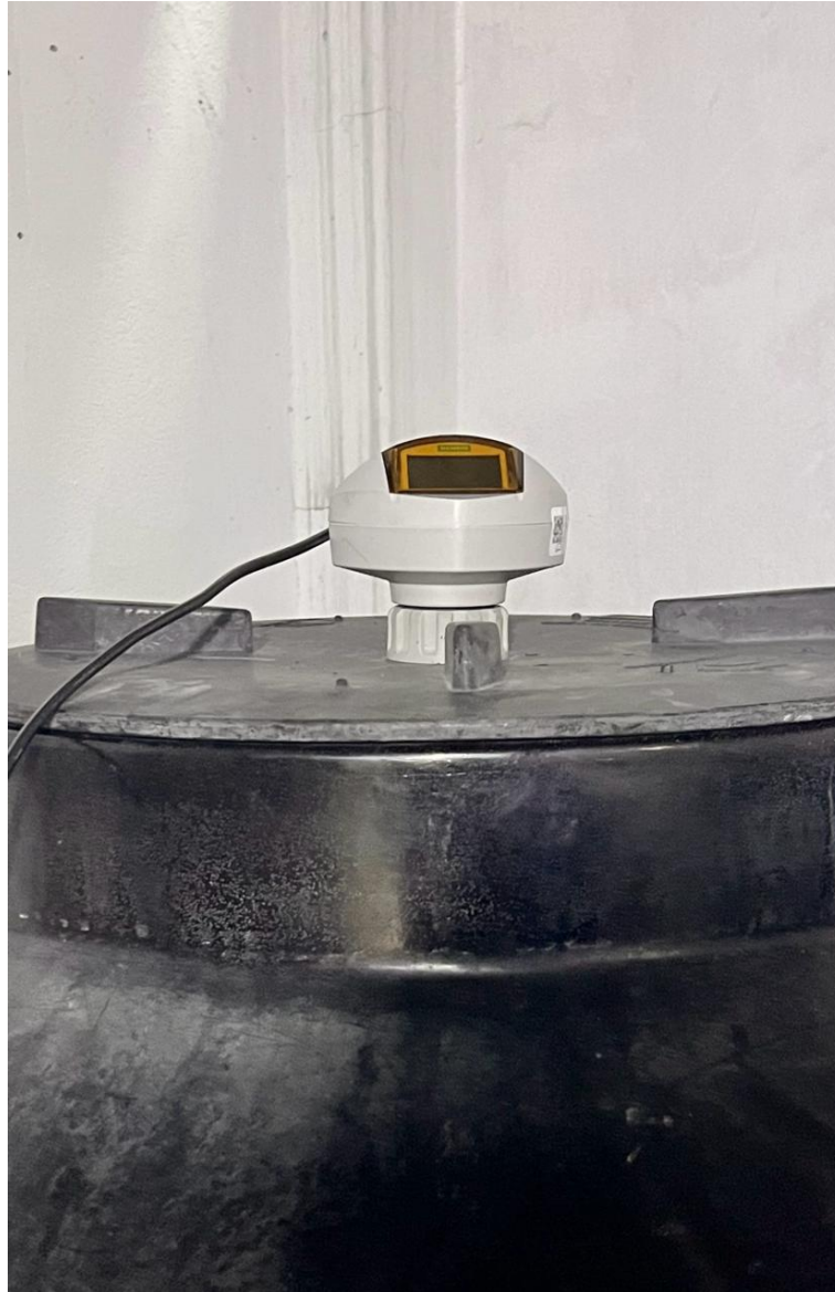
Figura 63. Instalación del sensor Ultrasonico Siemens Probe LU, por J. Solano y D. Ponce
