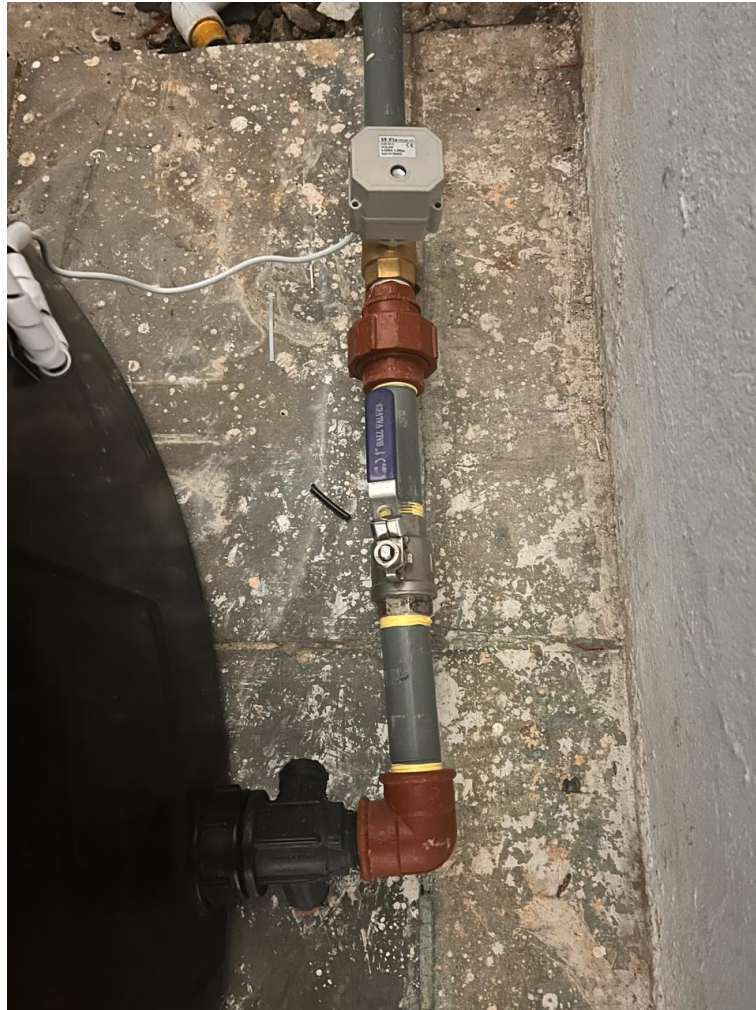
Figura 31. Válvula Motorizada de Descarga del tanque de Agua Filtrada
