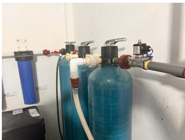
Figura 28. Valvula Solenoide en el Inicio de proceso de almacenamiento de agua
