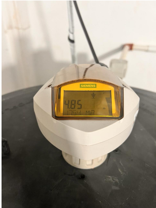
Figura 30. Valvula Motorizada en el Inicio de LLenado del tanque de Agua Filtrada
