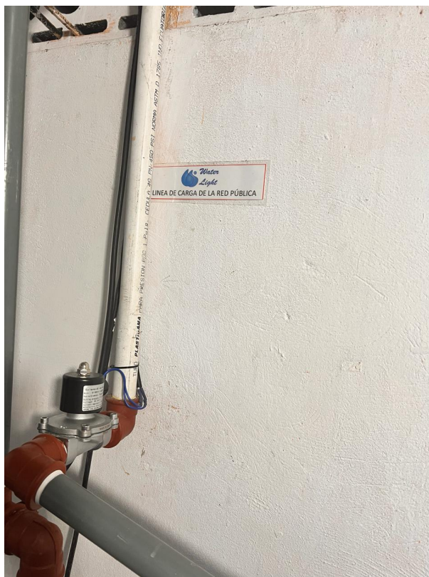
Figura 27. Valvula Solenoide en Tuberia de Red Publica para llenado de tanque de Agua Cruda
