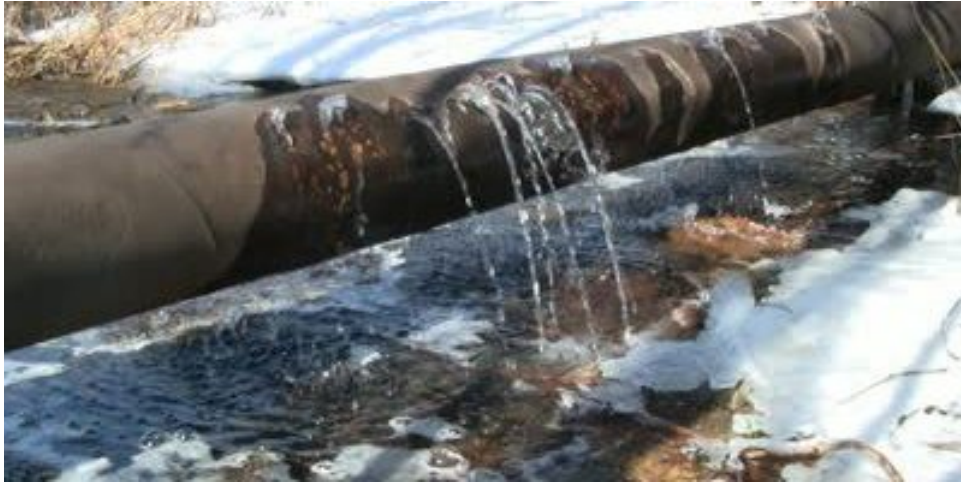
Figura 3. Fuga por rotura de tubería de agua potable.
