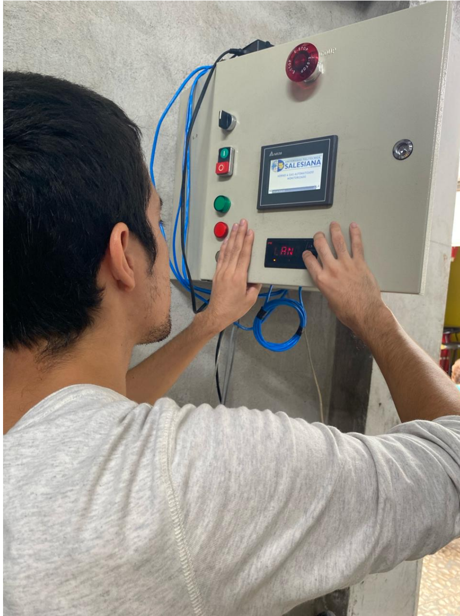
Figura 94. Cconfiguración del equipo en el tablero de control, por A. Chafía y N. Alava
