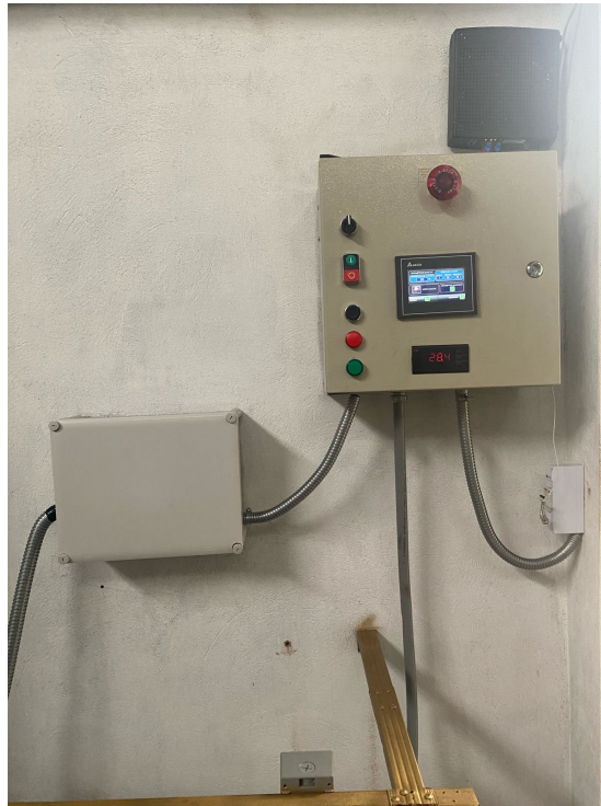
Figura 68. ensamble de equipos Fuente: Por A.Chafra y N. Alava
