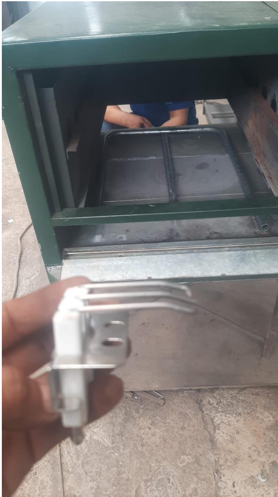
Figura 85. Colocación del chispero para el sistema automatizado, por A. Chafía y N. Alava
