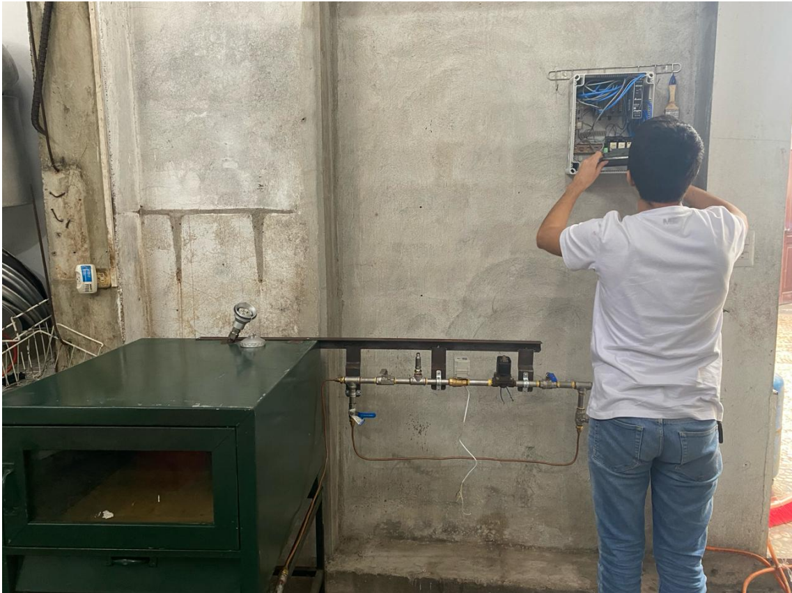
Figura 89. Conexiones de equipos en el tablero de control para el sistema automatizado, por A. Chafra y N. Alava
