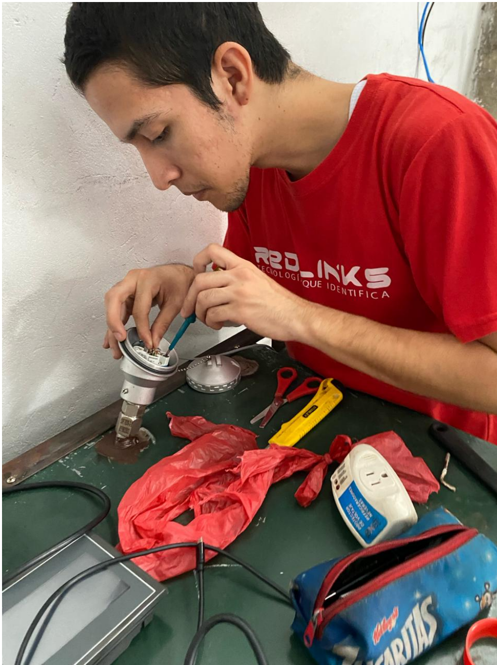
Figura 88. Conexiones de equipos en el tablero de control para el sistema automatizado, por A. Chafra y N. Alava
