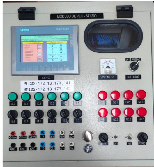
Figura 11 Elementos de control de un PLC S7-1200
