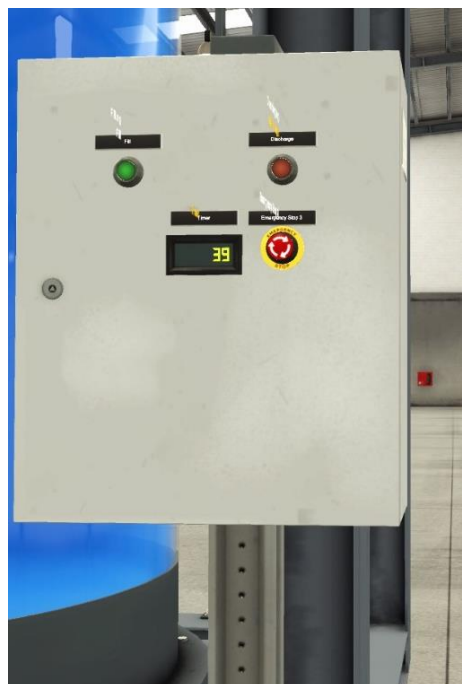
Figura 43: Ubicación de la caja de control en el Factory I\O
