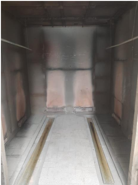
Figura 26.- Quemadores del Horno.
