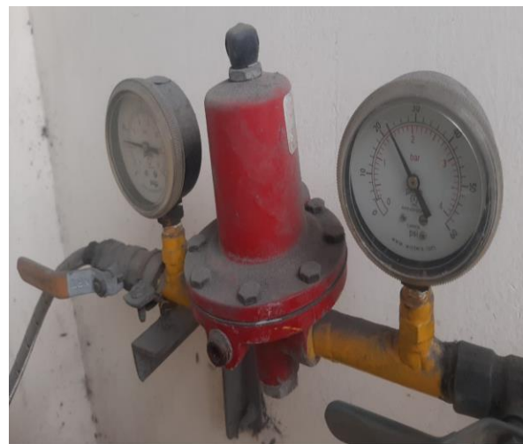
Figura 28. - Válvula de paso y Manómetros.
