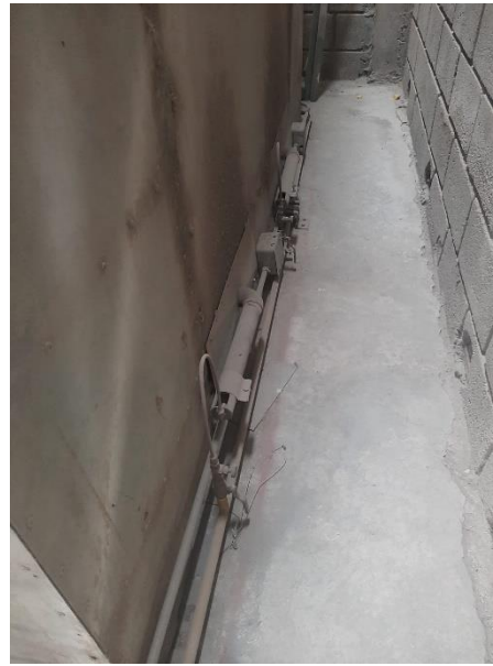
Figura 25. - Conducto de Tuberías de acero.
