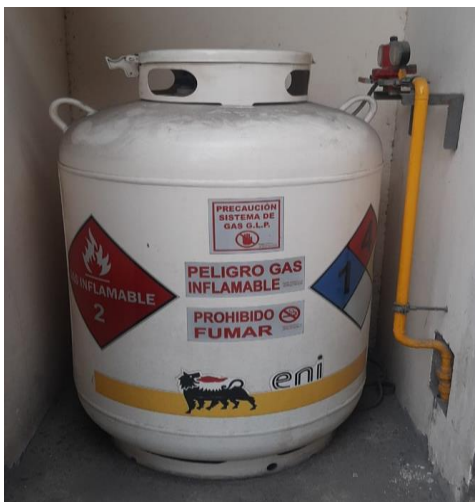
Figura 29. - Tanque de GLP.
