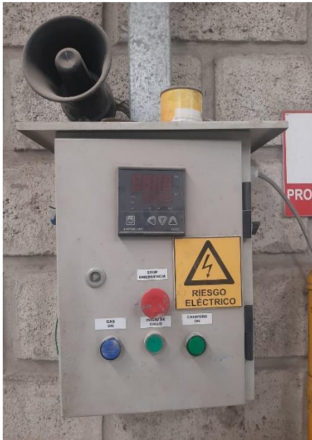
Figura 31. - Tablero de Control Convencional.
