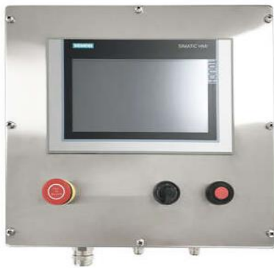
Figura 22. - Tablero de Control (Parte Externa).
