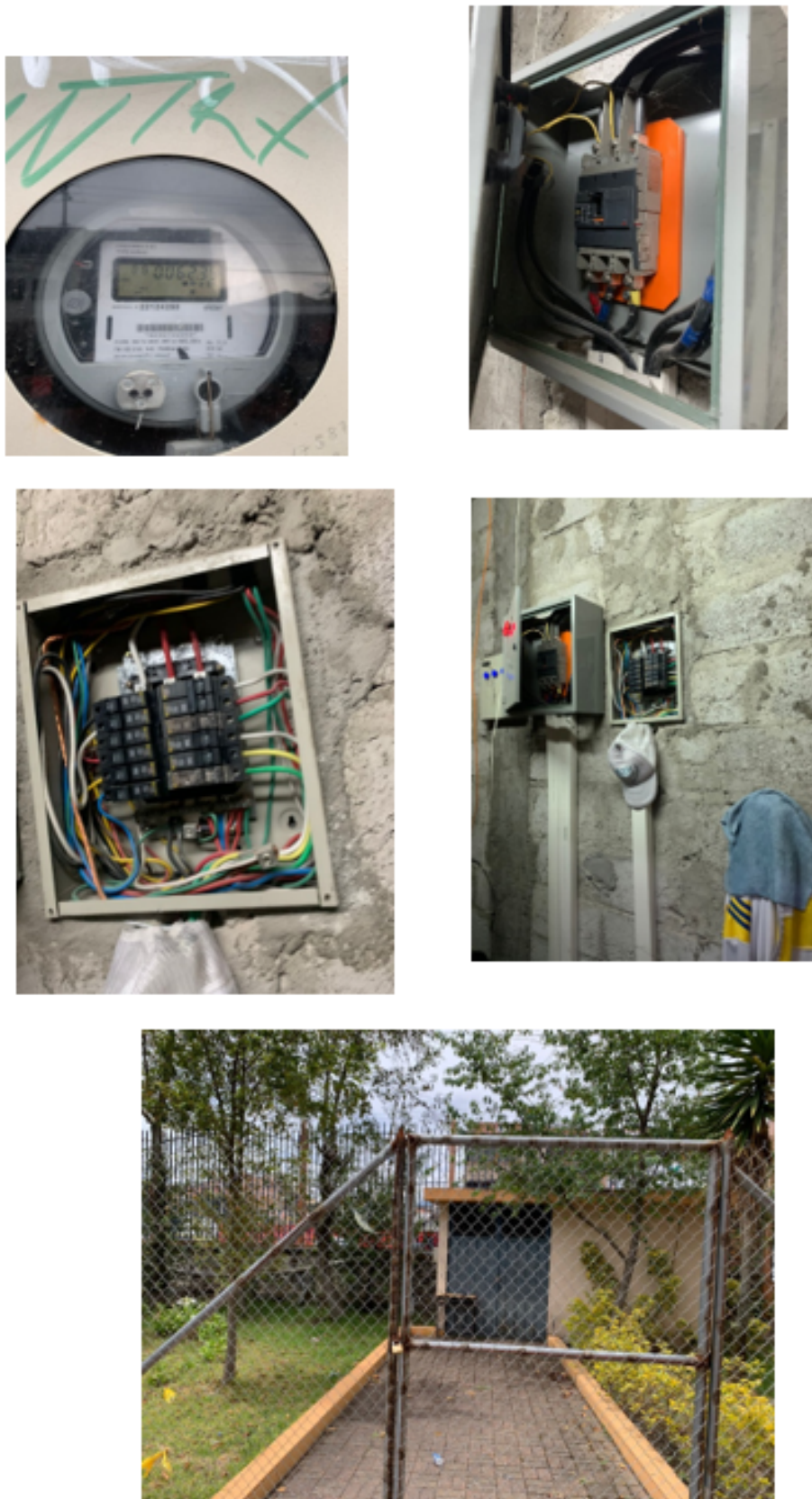
Figura 5.9: Ubicación y estado de cuadros de distribución
