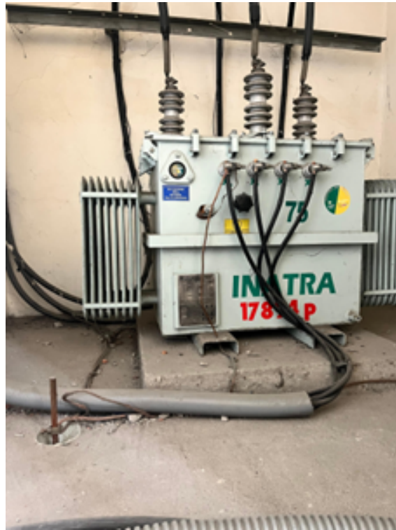
Figura 2.7: Transformador Inatra 75kVA
