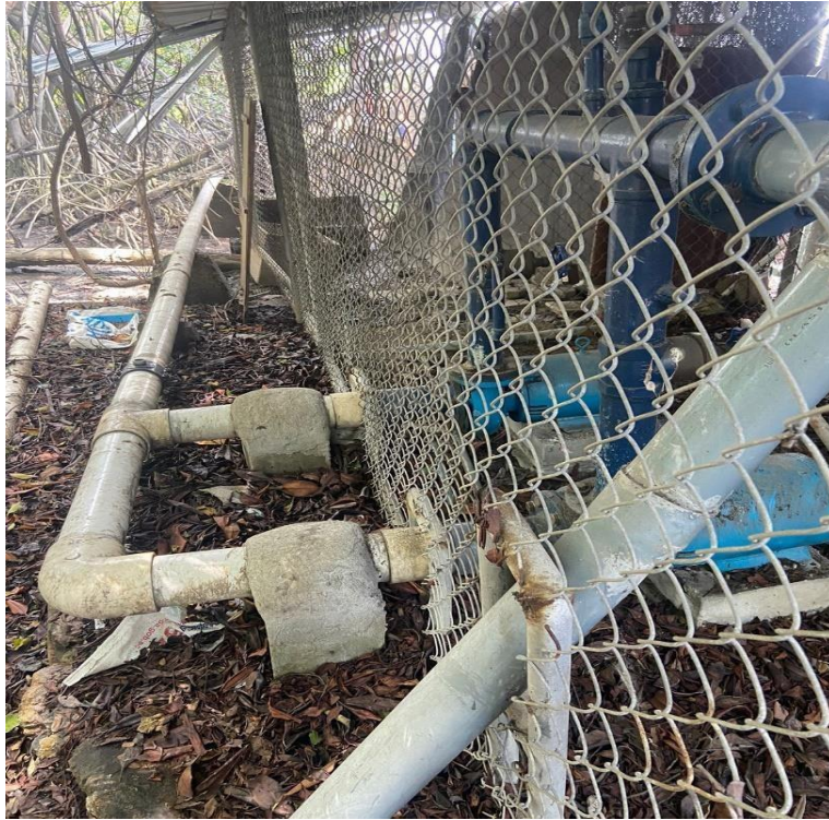
Anexo Fotográfico 1. Bombas que extraen el agua del río Daule y que se conectan con las cisternas.
