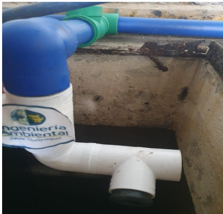
Figura 11 Filtro piloto en funcionamiento
