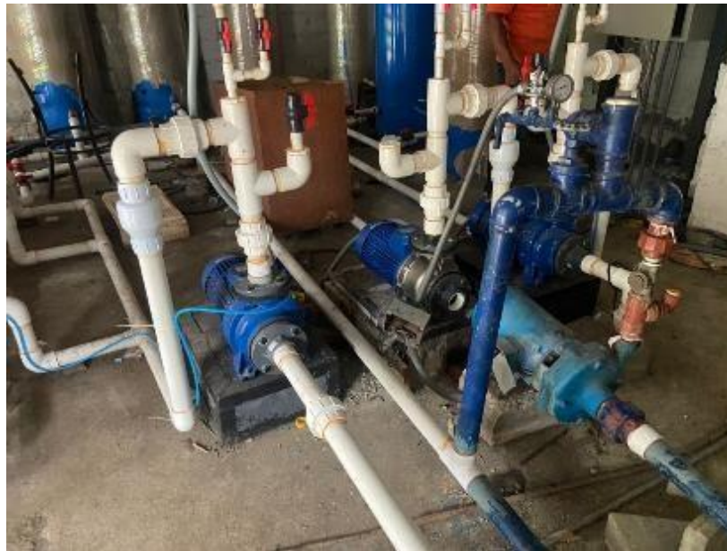
Anexo Fotográfico 4. Tuberías de Bomba de Agua que van hasta la cisterna para su llenado.
