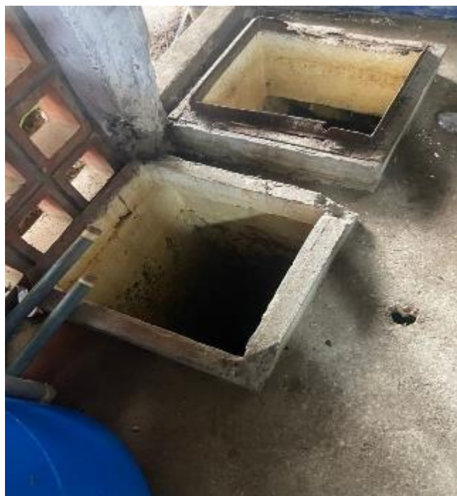
Anexo Fotográfico 10. Cisterna de Agua potable proveniente de la puntilla.
