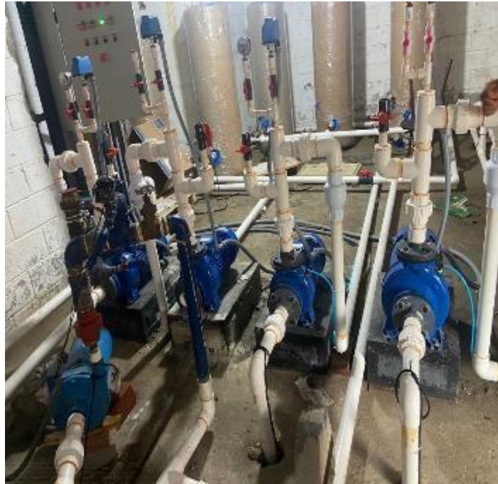
Anexo Fotográfico 7. Bombas de Agua que conectan con el agua potable de la puntilla.
