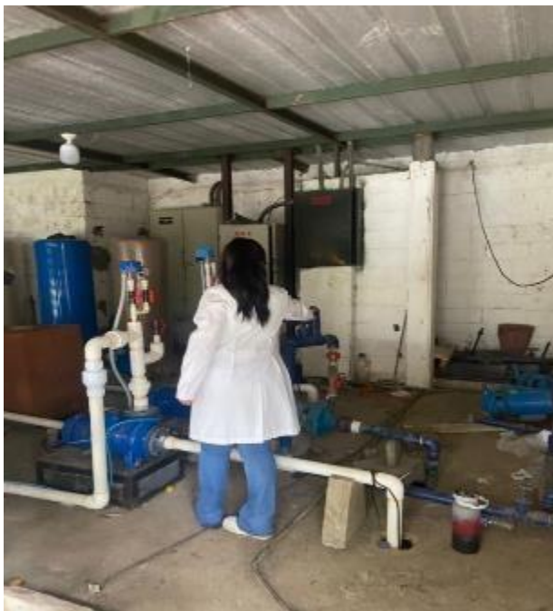
Anexo Fotográfico 5. Revisión de manómetro para ver presión de agua en Bomba de Agua que conecta con el Río Daule.
