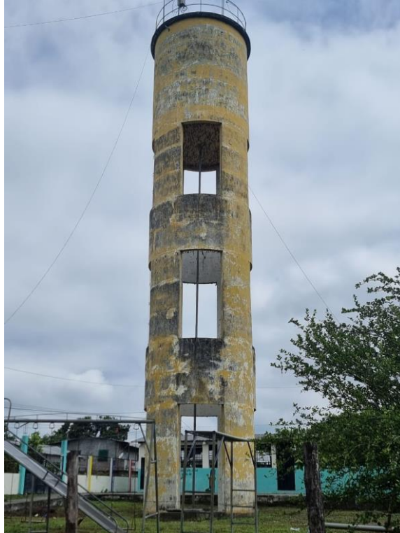
Imagen 5 Tanque de almacenamiento del recinto Yumes, Palestina.
