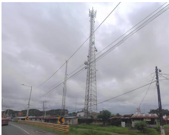
Ilustración 10: Imagen referencial de torres de comunicación
