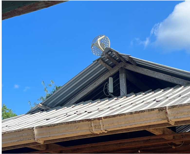
Figura 2.7: Ubicación de la antena sobre techo de metal.
