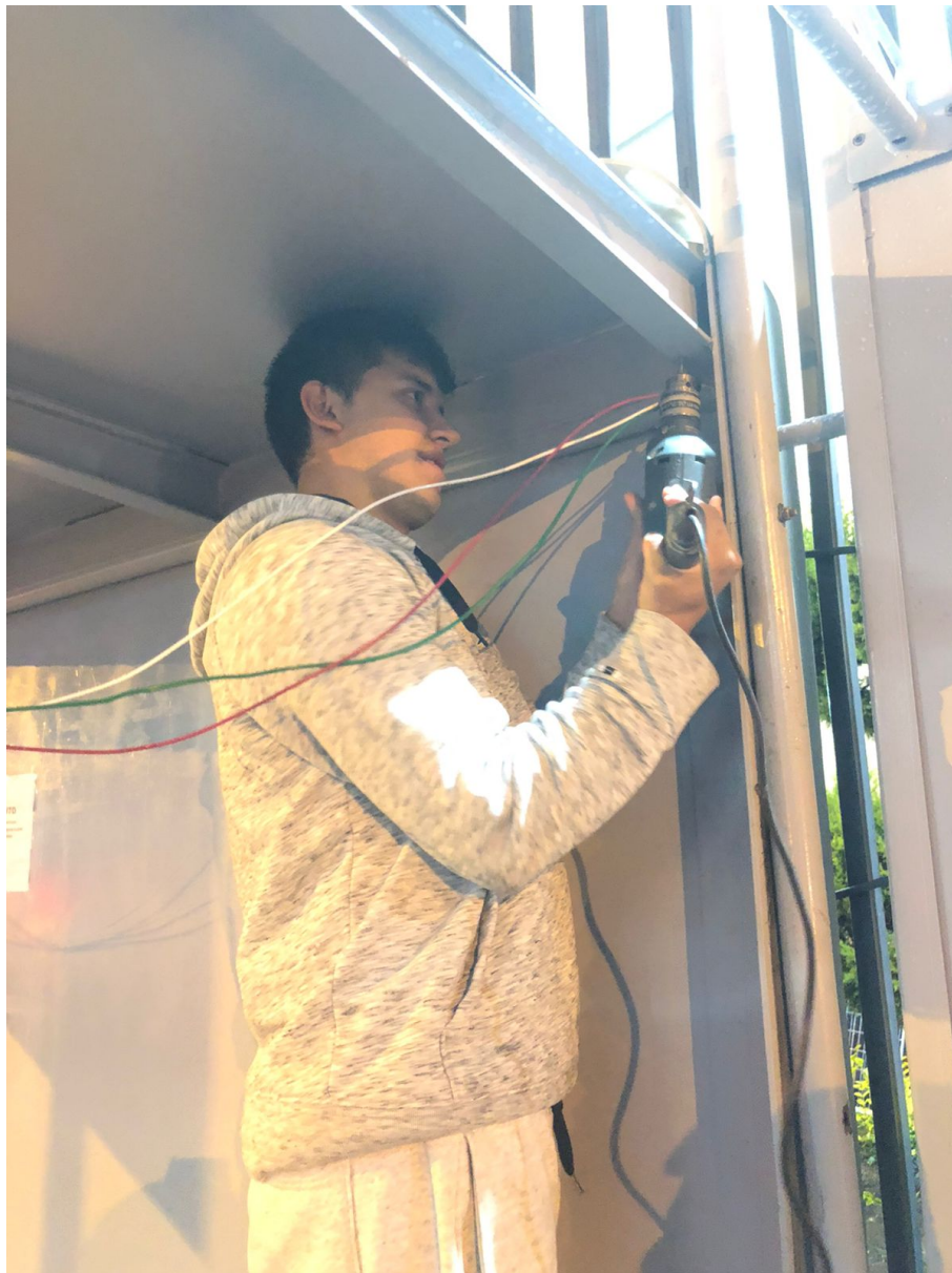
Figura 12: Abertura de agujeros en la parte superior de la parada de bus para el traspaso del cableado para las luminarias
