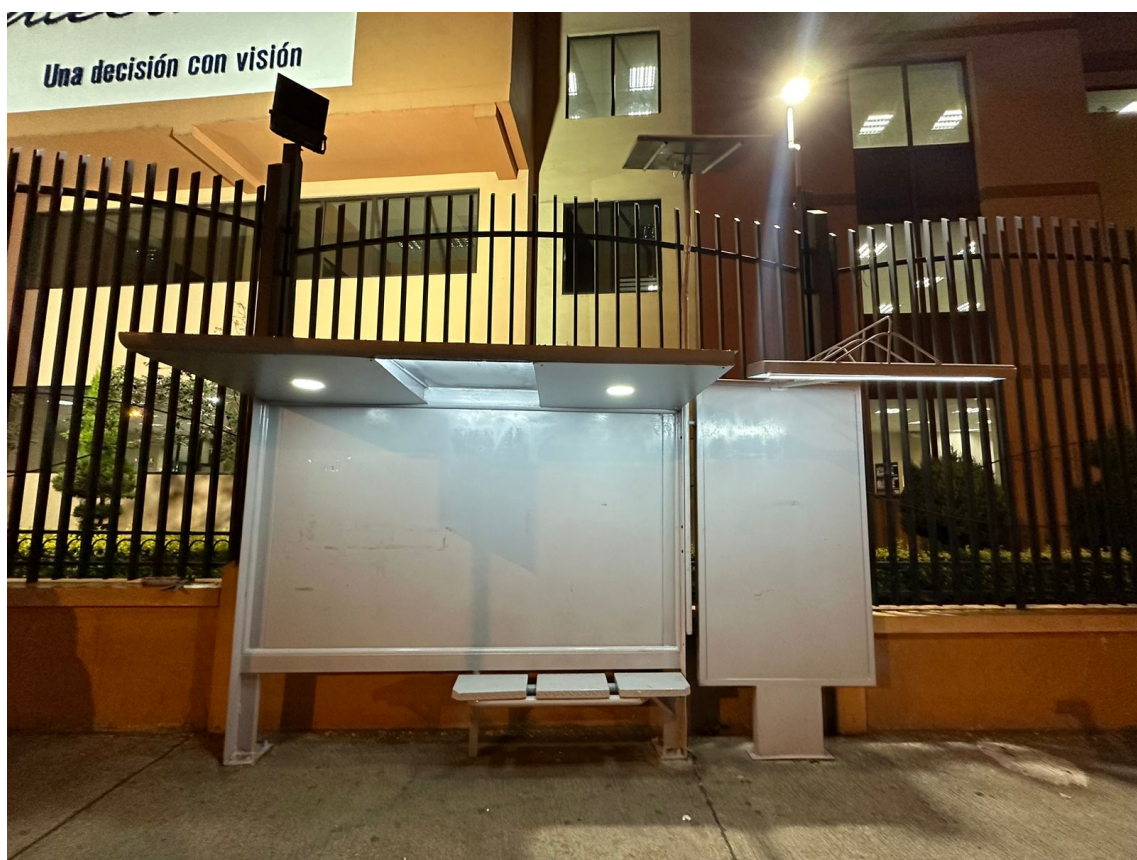
Figura 39: Parada de bus con circuito de iluminación completa
