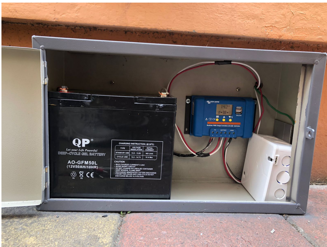
Figura 35: Tablero eléctrico fotovoltaico.
