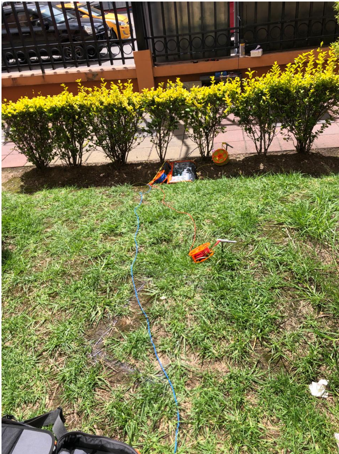
Figura 29: Instalación de Teluometro en serie.
