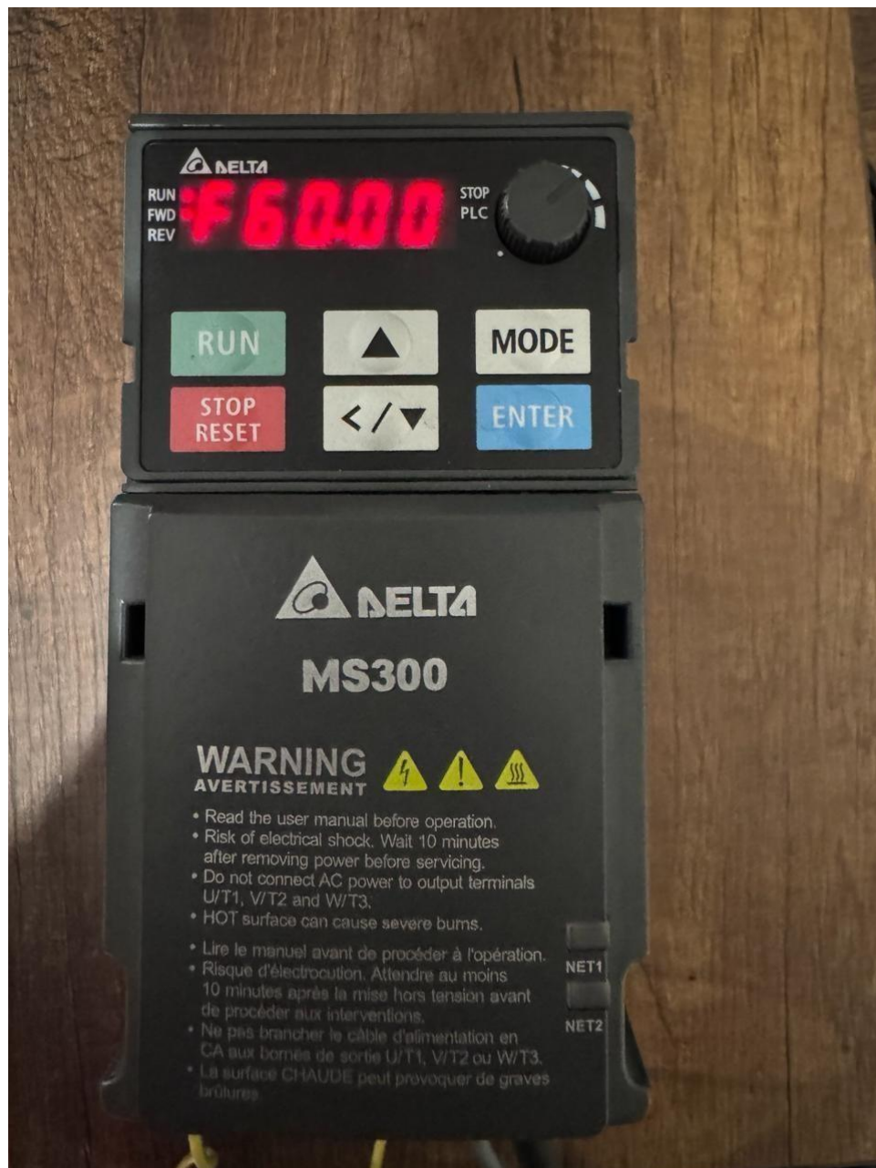
Figura 3.39: VFD Frecuencia 60Hz
