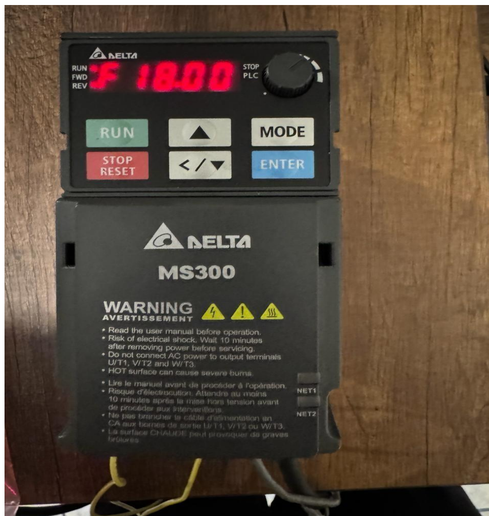
Figura 3.33: VFD giro Antihorario
