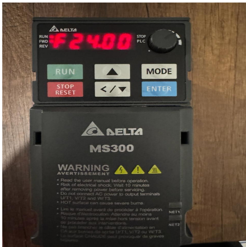
Figura 3.37: VFD Frecuencia 24Hz
