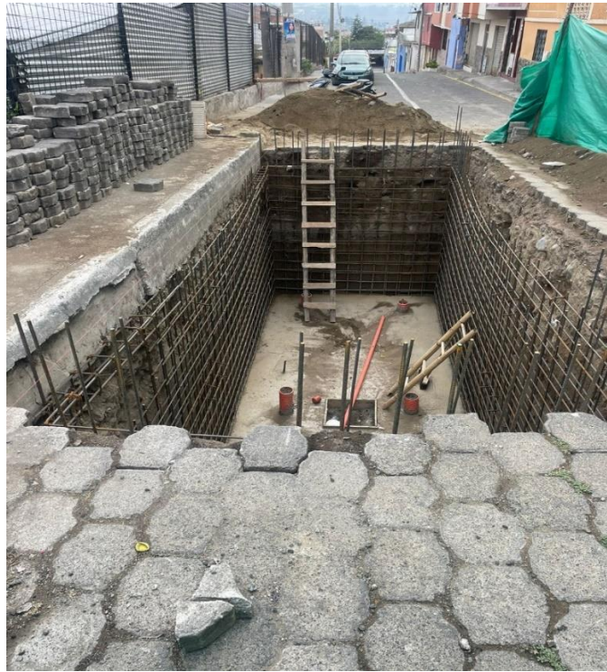
Figura 29. Cámara de Seccionamiento
