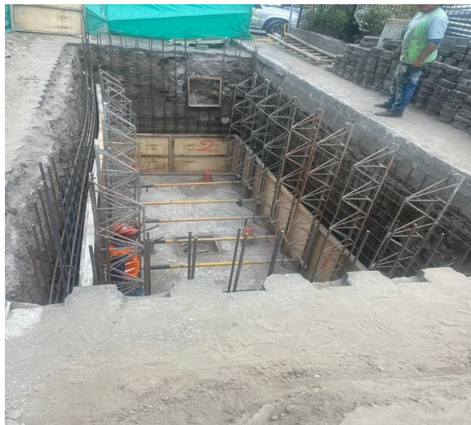
Figura 28. Cámara de Transformación
