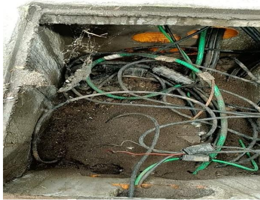
Figura 20: Empalmes de Alumbrado Público
