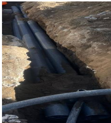
Figura 24. Tubería de Telecomunicaciones
