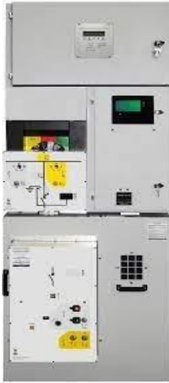
Ilustración 11, celda de media tensión [21].
