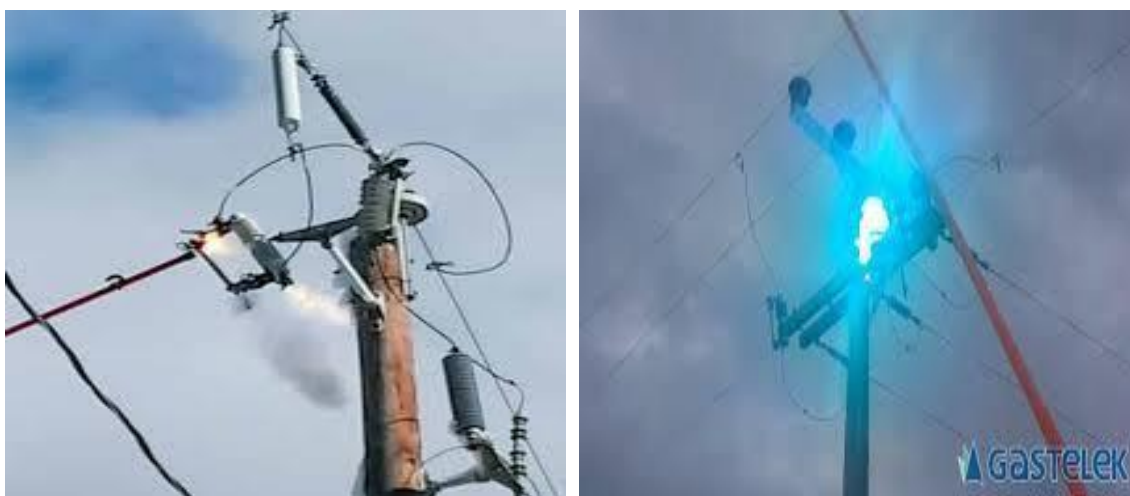
Ilustración 7, ejemplos de fallas eléctricas
