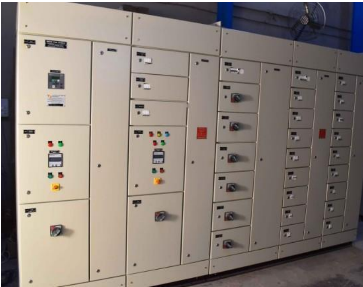
Ilustración 19, PCC (Centro de control de energía) [27].
