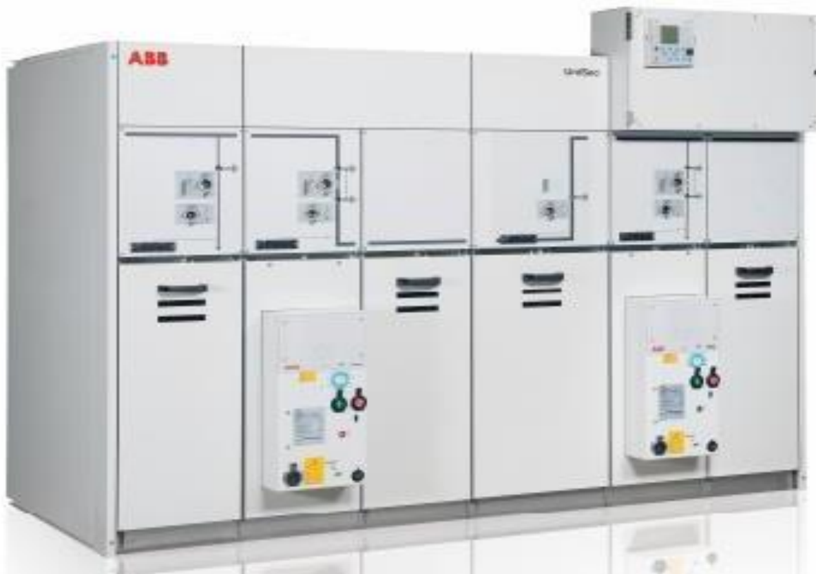
Ilustración 18, Celdas de Distribución Secundaria [30].
