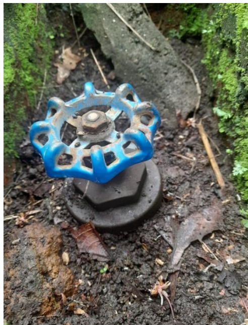
Imagen 25: Llave de paso instalada
