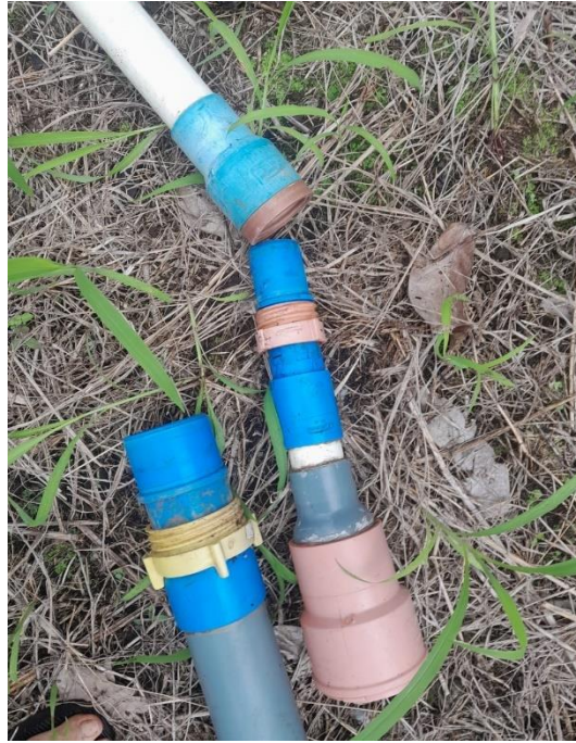
Imagen 28: Tubería de empate de 3" a una de 2"
