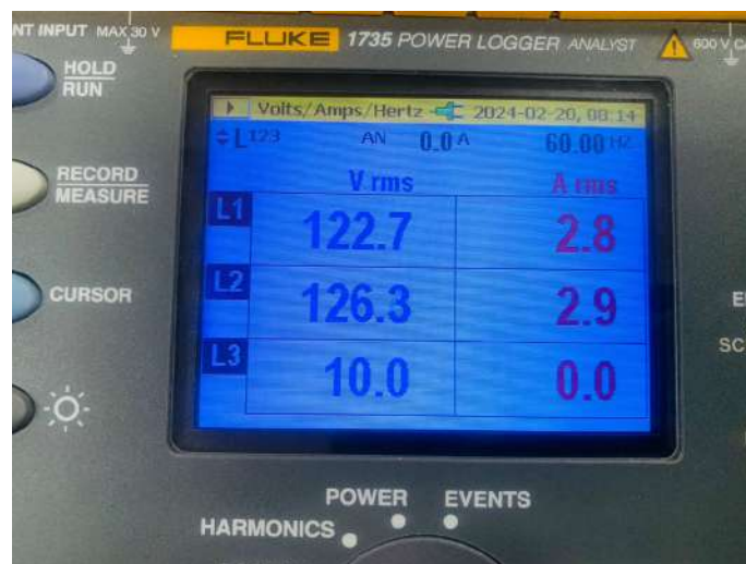
Figura C.5: Medición de voltaje y corriente
