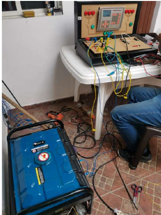
Figura C.2: Prueba para encendido del generador desde el tablero.
