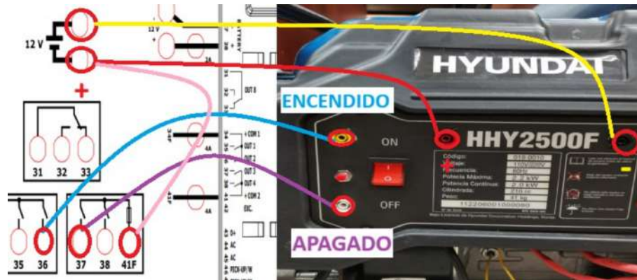
Figura 3.10: Conexión de arranque y magneto de apagado Fuente: Autores.
