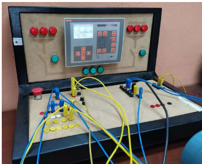
Figura B.3: Tablero de control y conexión.
