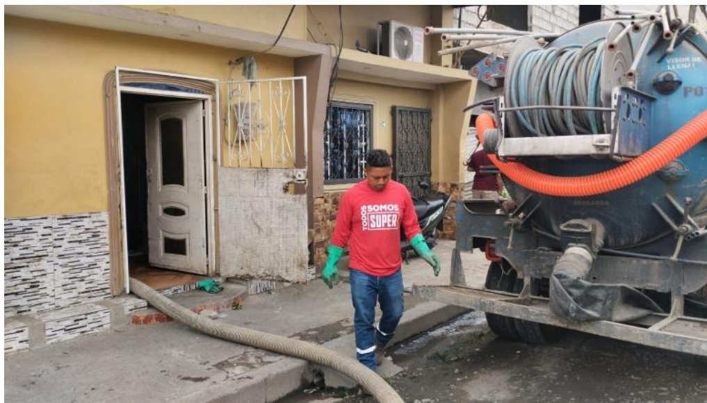
Fotografía 2. Limpieza de pozo séptico ubicado en la parte trasera de una casa.
