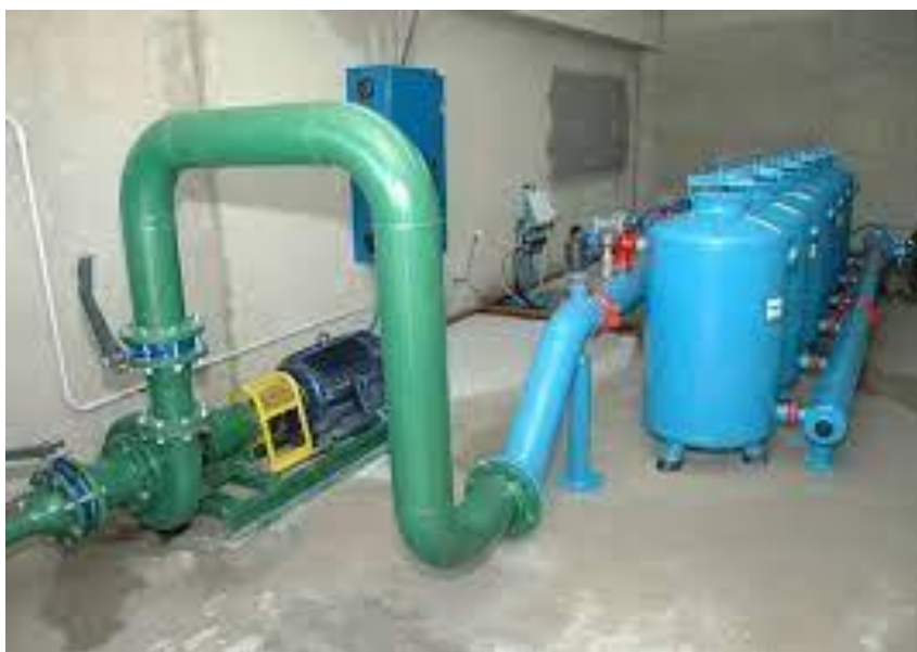
Registro fotográfico No. 14
