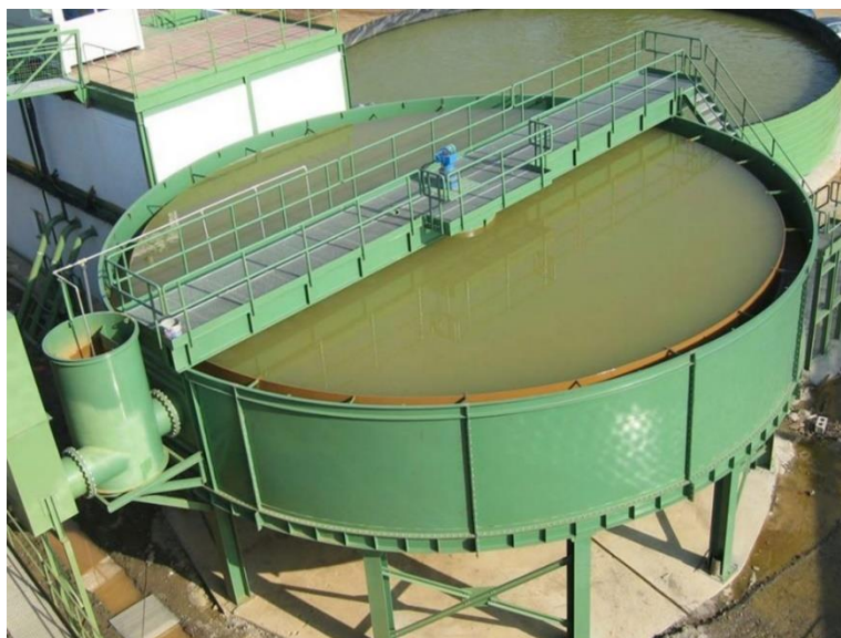
Registro fotográfico No. 13
