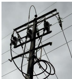
Ilustración 5, Seccionadores y pararrayos (Urbanización villa club)
