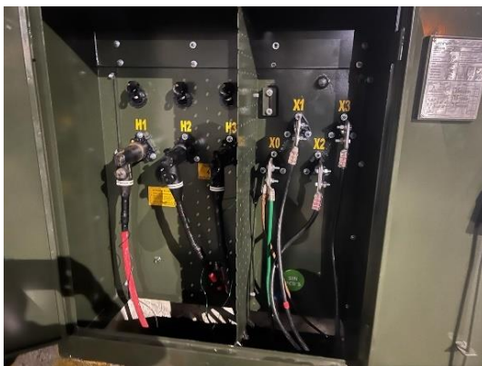
Ilustración 16, Transformador trifásico tipo radial (Urbanización villa club).
