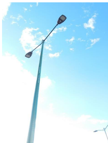
Ilustración 19,. Iluminaria LED (CNEL.EP-2022).
