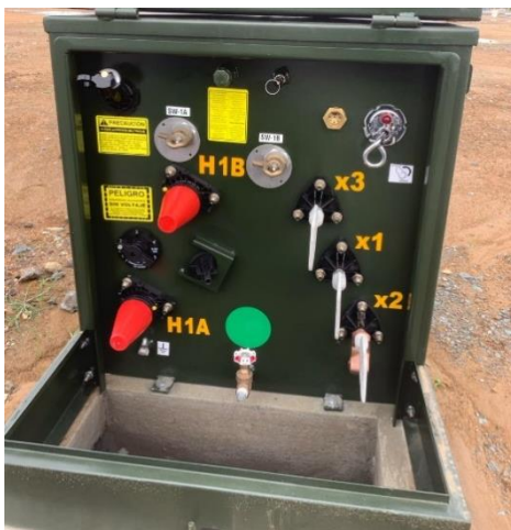
Ilustración 17, Transformador trifásico tipo anillado (CIUDAD CELESTE 'BABOR').
