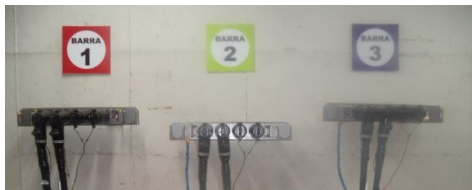
Ilustración 10. Conductos subterráneos para la distribución eléctrica. (EEASA-2020)
