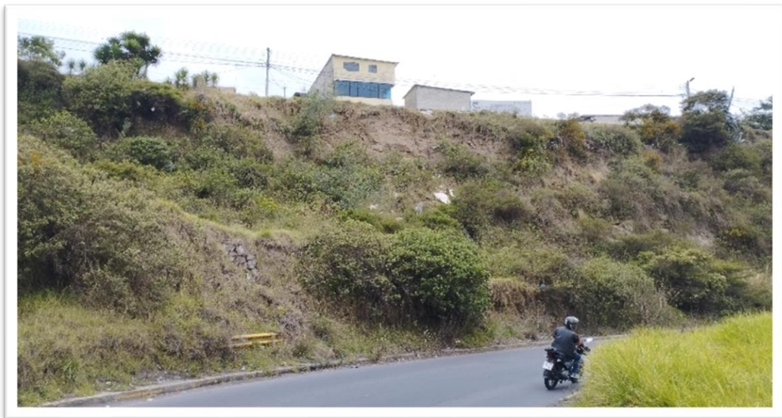
Nota: Vegetación presente sobre la cara del talud
