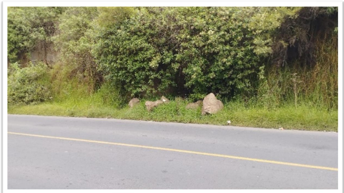
Nota: Bloques de suelo desprendidos del talud
