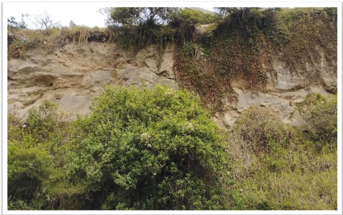
Nota: Formación de pequeños bloques y fisuras por el efecto de erosión del suelo
