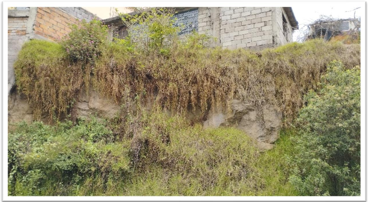
Nota: Vivienda deshabitada por el peligro inminente de colapso del talud
