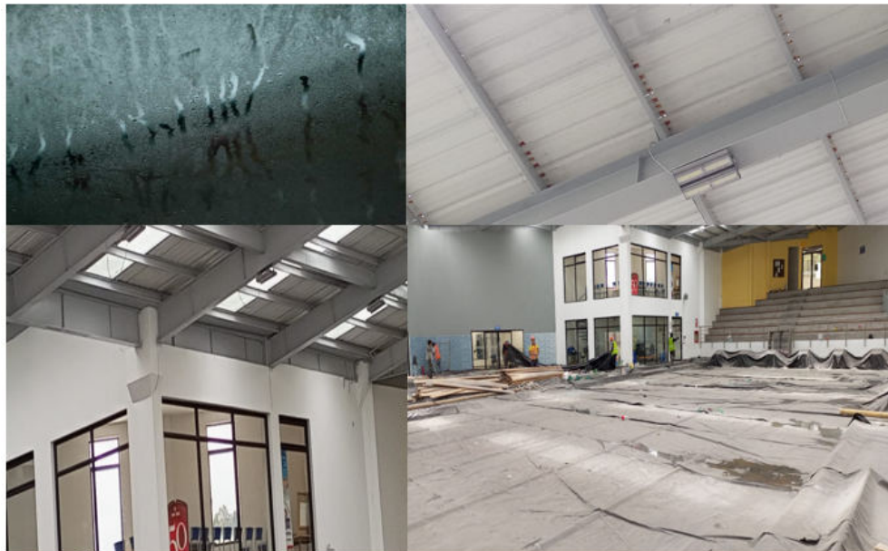
Figura 68. Condensación en el techo y mampostería.
