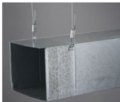
Figura 46. Ducto sujetado con tensores
