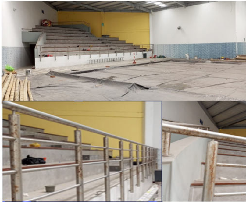
Figura 67. Corrosión en pasamanos.
