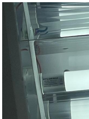
Figura 74 Marca de las luminarias actuales
