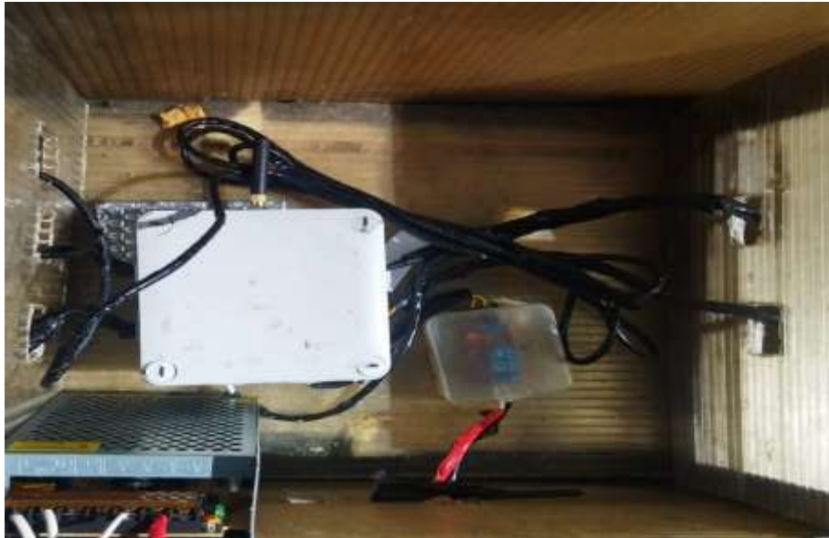
Figura 47 Vista interna desde la caseta del nodo transmisor [Autor]
