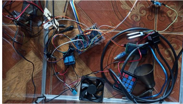
Anexo 7 Prueba de sensores y actuadores
