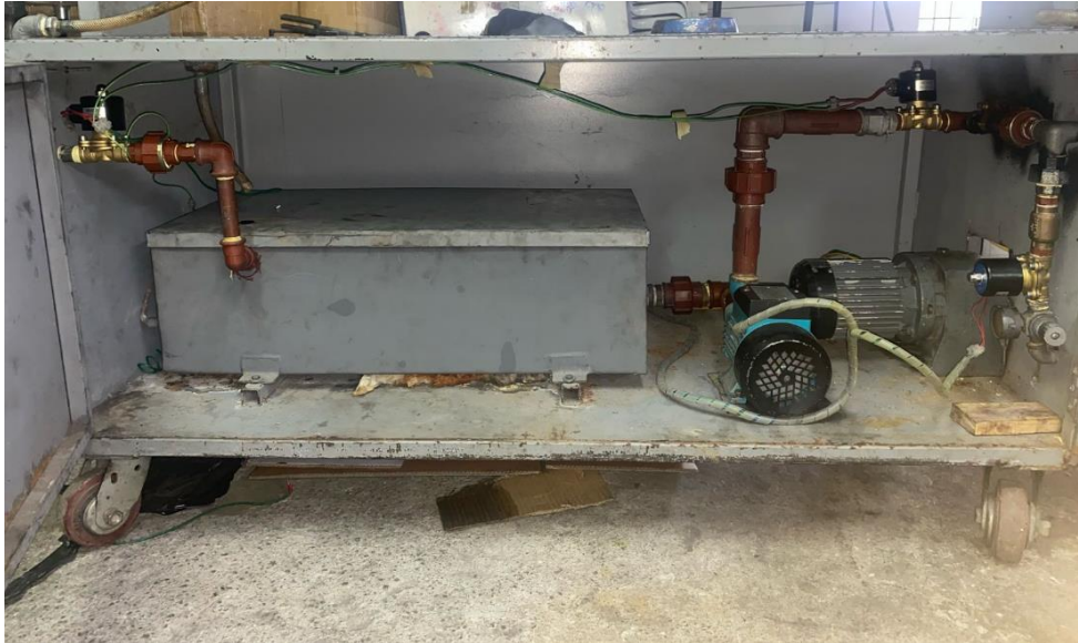
Figura 34. Tubería de agua y aire
