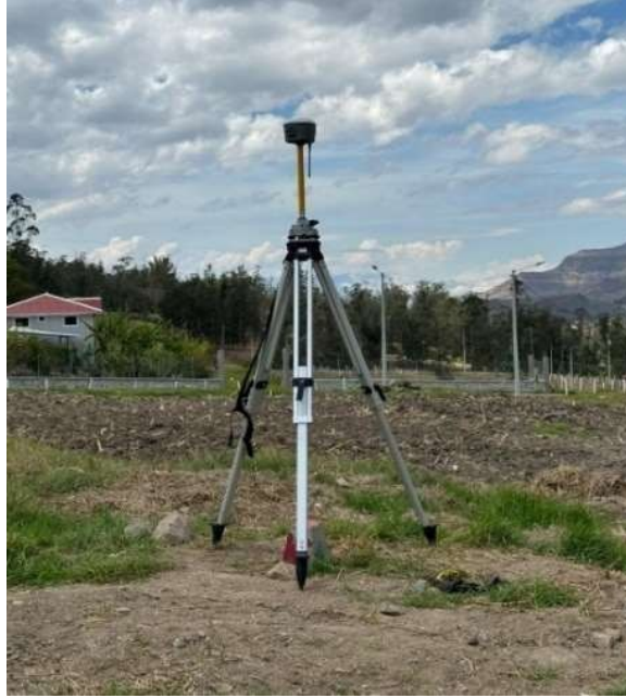
Ilustración 25: Base del RTK en la zona de trabajo.
