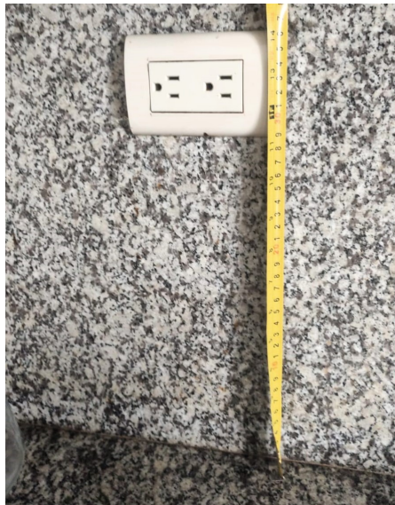
Figura 24: Tomacorriente sobre el mezon en el área de la cocina
