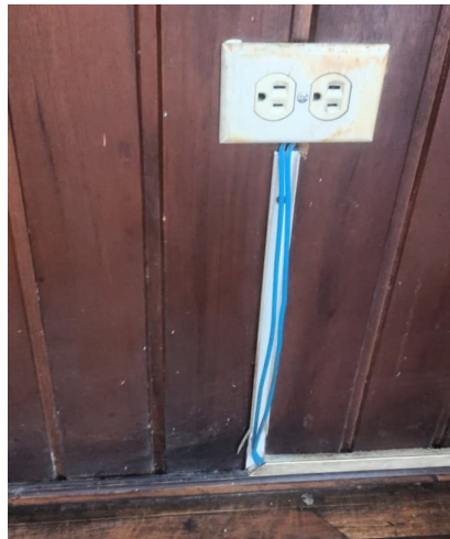
Figura 26: Tomacorriente sin adecuada protección
