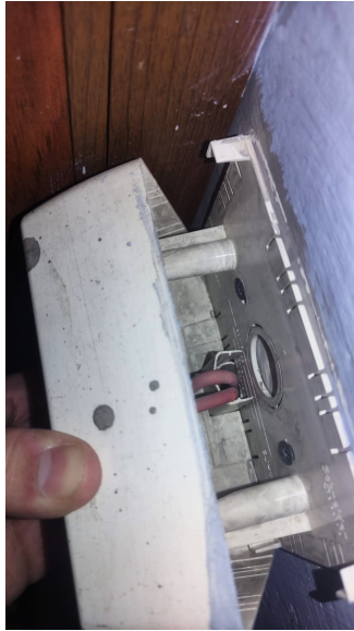
Figura 29: Tomacorriente sin conexión a tierra
