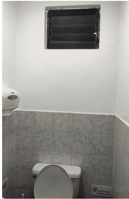
Figura 27: Ventilación del baño tipo rejilla
