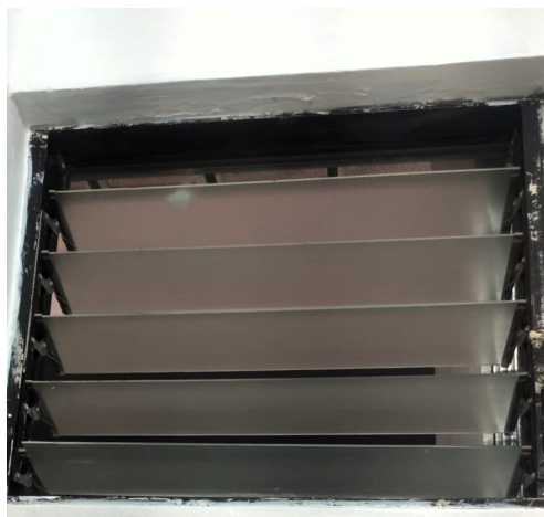
Figura 31: Ventilación tipo rejilla en el área de laboratorio
