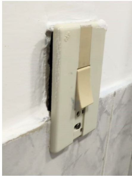
Figura 21: Interruptor en mal estado
