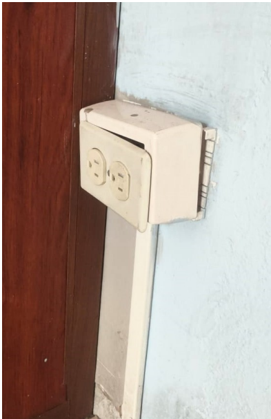
Figura 25: Tomacorriente sobrepuesto en mal estado
