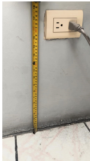
Figura 30: Tomacorriente con altura correcta, sin embargo no cuenta con la protección contra la intemperie en el área de lencería
