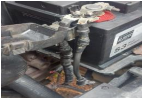
Figura 2- 12 Cables de batería
