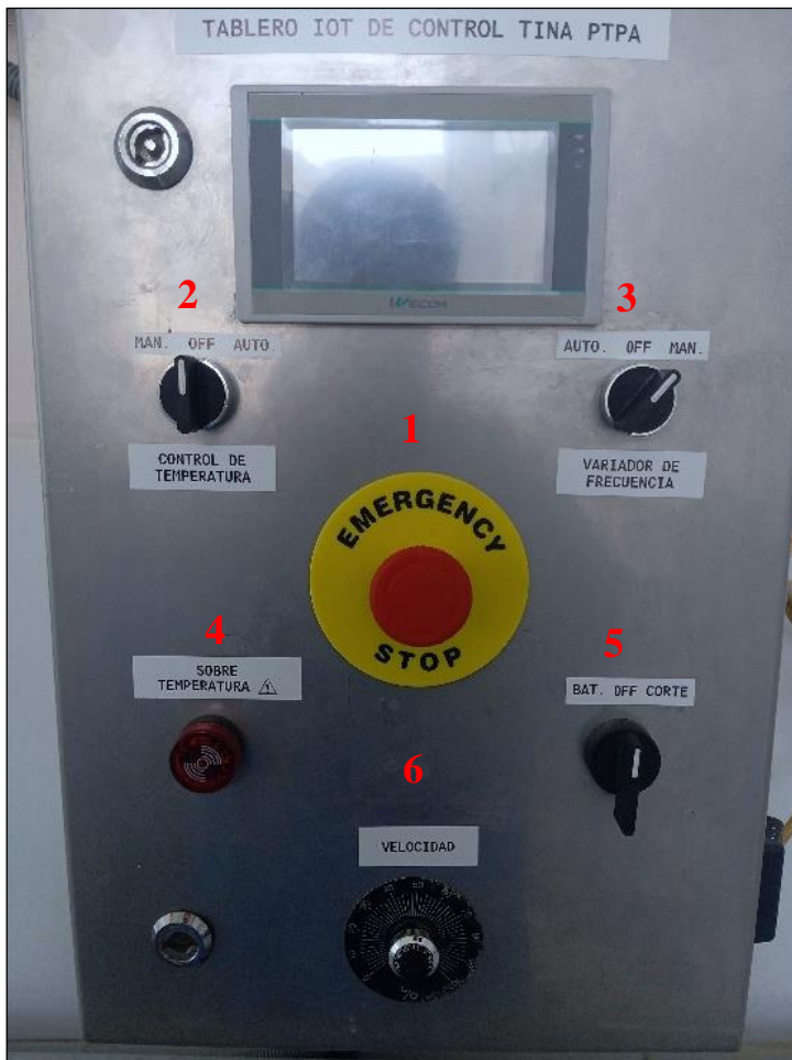
Figura 31: Frontal del tablero de control en la planta. (Fárez & Masalema, 2023)
