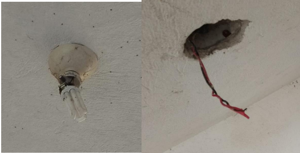
Figura 29. Instalaciones eléctricas inadecuadas.
